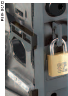
Abschließen in der „Trennstellung“ über Vorhängeschloss
