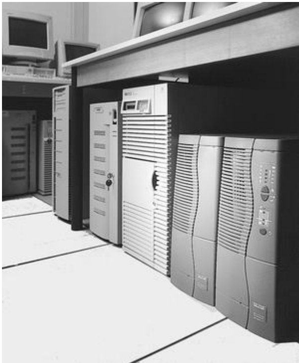
Abb. N30b: USV-Anlage zur besseren Versorgungskontinuität und -qualität für rechnergestützte Systeme
