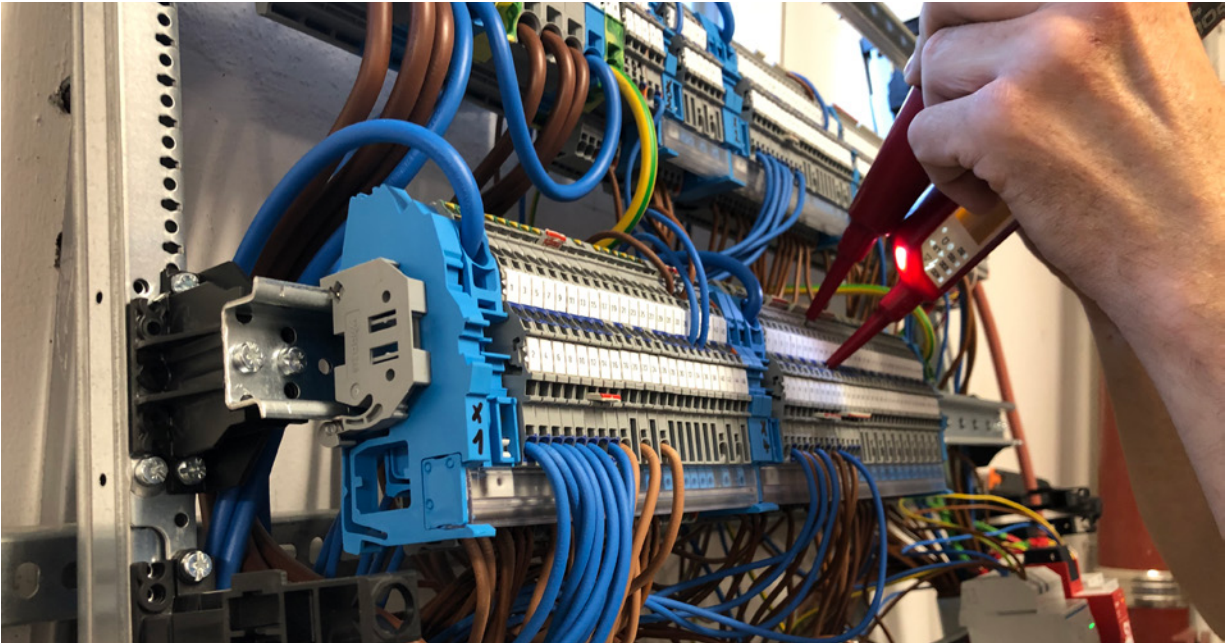
Die WAGO Reihenklemmen mit N-Trennung erleichtern die Fehlersuche in elektrischen Anlagen. Außerdem können Elektroinstallateure bereits auf der „Werkbank“ prüfen, ob im Stromkreisverteiler alles richtig verdrahtet ist. Das spart Zeit auf der Baustelle. Foto: jb electro
