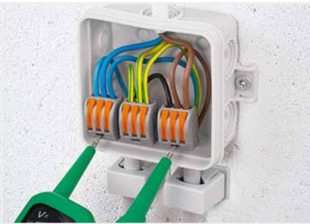
Prüfen der installierten Klemmen
