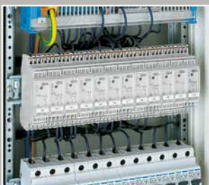
Relais, Interface-Module, Netzteil
