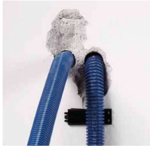
Bild 20: Elektroinstallationsrohre mit Schienenbefestigung (Klicksystem)
