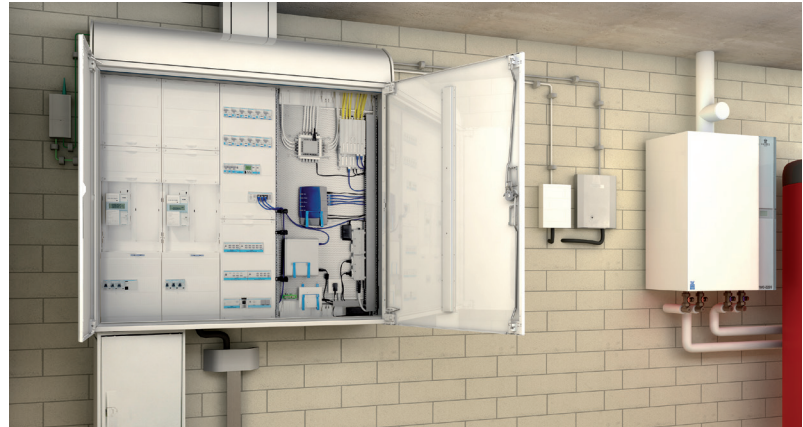
Bild 5: Moderner Zählerschrank mit elektronischen Elektrizitätszählern (Smart Meter) und zusätzlichen Kommunikationseinrichtungen
