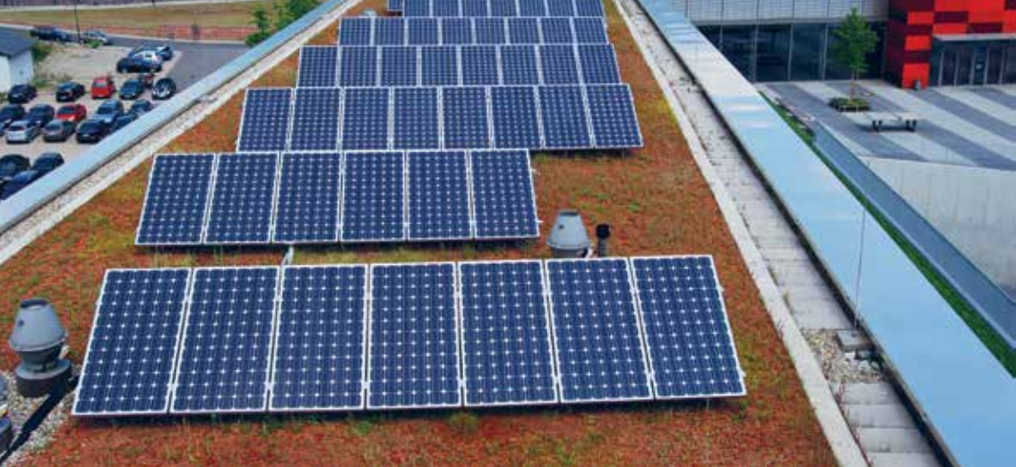
Photovoltaikmodule auf extensiv begrüntem Dach, Blick über Anlage. Donnig + Unterstab Architekten, Schulzentrum. Neckargmünd, Deutschland.
