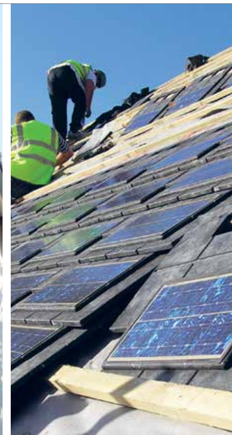
Polykristalline Zellen. Bausteine. Kombination aus Dachziegeln mit Photovoltaik-Modulen.
