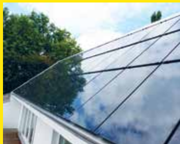
Dachfläche aus Photovoltaik-Modulen auf bestehendem Gründerzeithaus. 1140 Wien, Hadikgasse 24.
