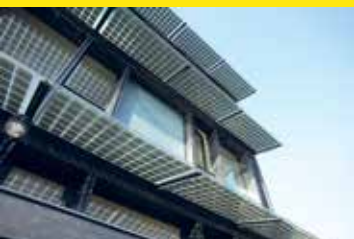
Photovoltaikmodule als Abschattungslamellen. Privathaus. Paris, Frankreich.
