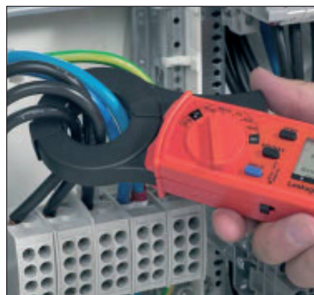
Differenzstrommessung mit Leckstromzange
