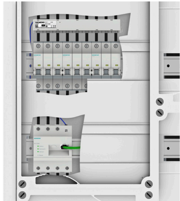
Mehrkanal-Strommesssystem 7KT PAC1200 eingebaut
