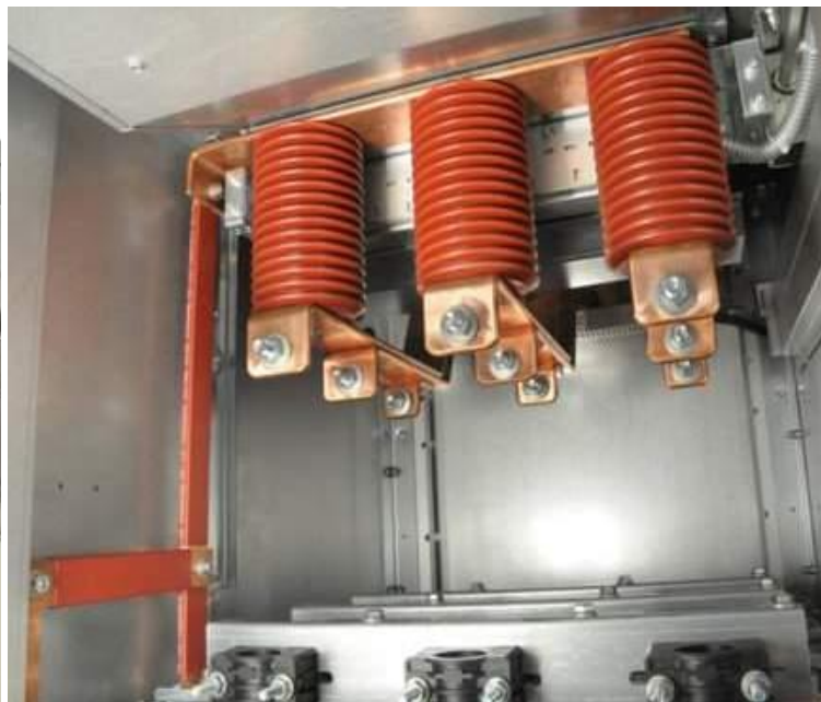
UFES em UniGear - Instalação em compartimento de cabos
