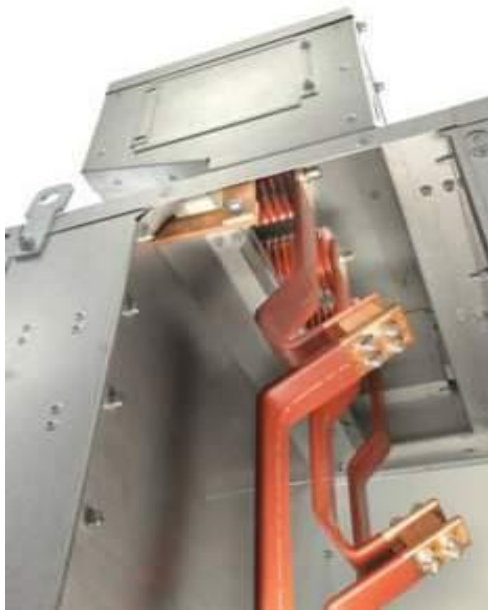
UFES em UniGear – Instalação Top- Box
