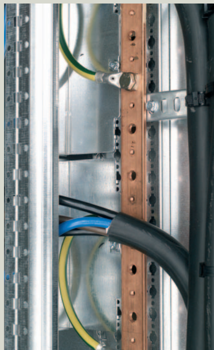
Terminal principal na cela de cabos consistindo em uma barra de cobre 32 x 5 mm
