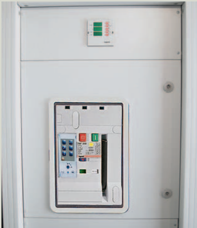
Unidade de medição central ref. 146 65 em espelho frontal cego no topo do painel de distribuição
