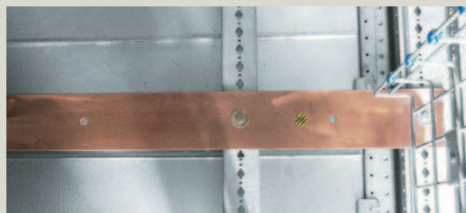
Terminal principal consistindo de uma barra de cobre no fundo do painel de distribuição
