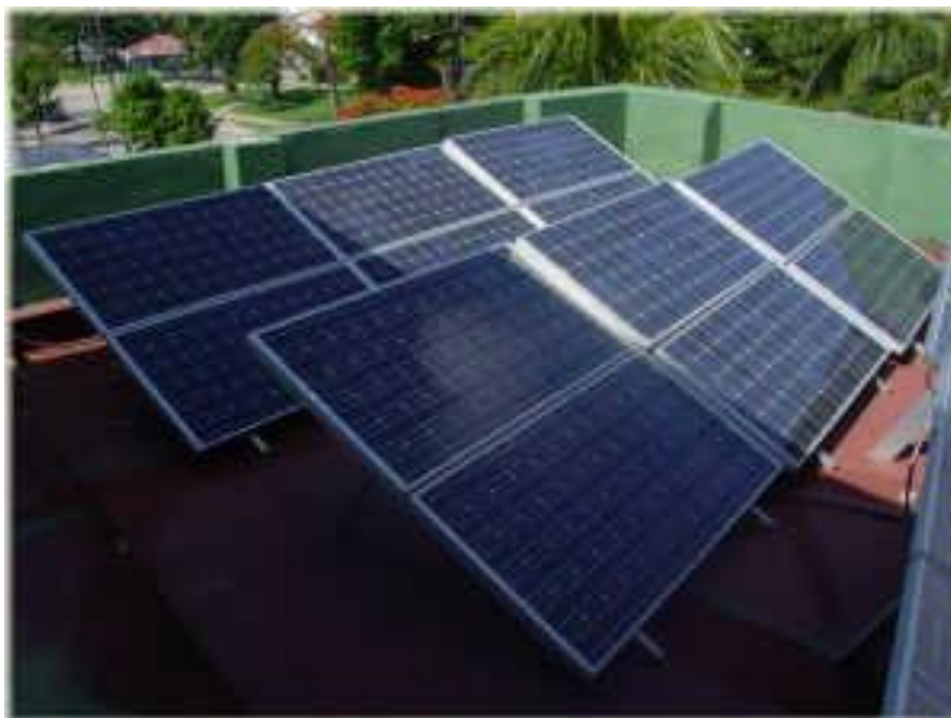
Figura 69 – Sistema fotovoltaico em cobertura sombreado por elemento construído.
