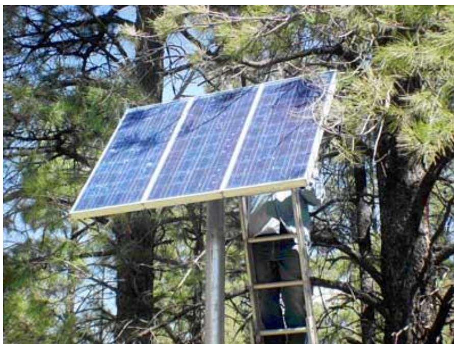
Figura 70 – Sistema fotovoltaico sombreado por árvores.
