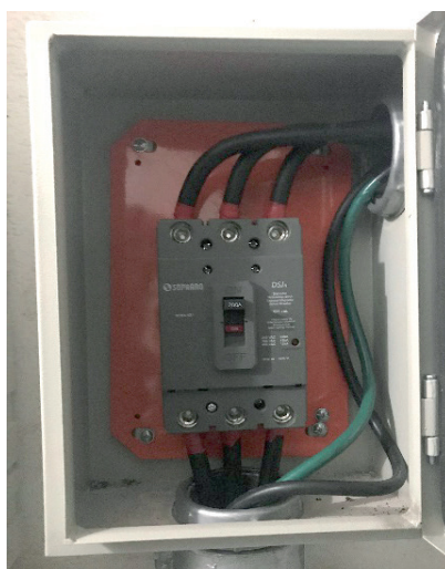
Imagem 8 - Quadro sem equipotencialização
