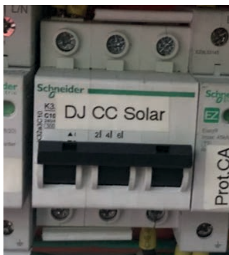
Imagem 2 - Disjuntor CA utilizado em CC
