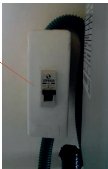
Imagem 15 - Disjuntor de CA utilizado em CC
