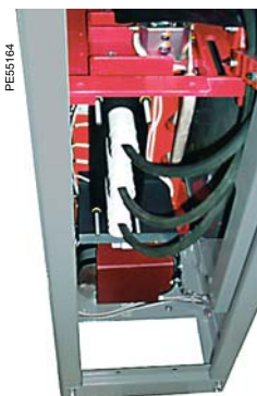
Entrada dos cabos na estrutura
