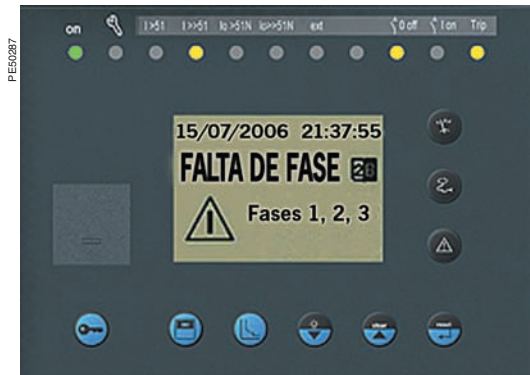
Sinalização local no painel frontal do Sepam.
