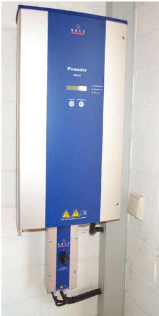
Bild 8: Wechselrichter mit DC-Freischalttestelle (Quelle: Bonhagen)
