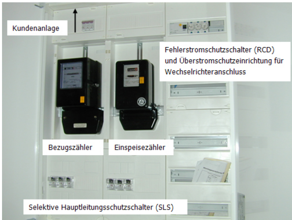
Bild 13: Zähleranlage mit Bezugs- und Einspeisezähler
