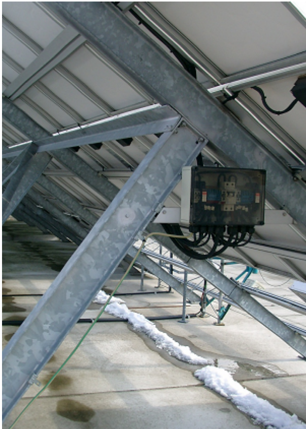
Bild 3: Generatoranschaltkasten mit Überspannungsschutz (Quelle: Phoenix Contact)
