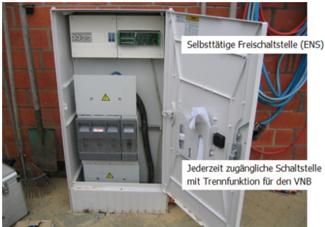
Bild 12: Einspeisestelle für Anlagen größer 30 kWp
