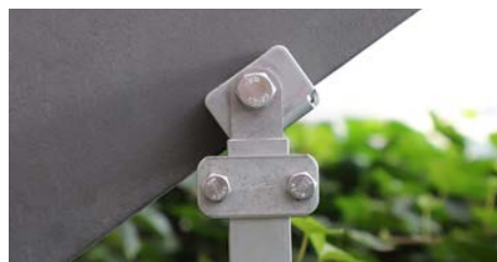
Verbindung Stahlträger mit Anschluss- fahne / Erdungsanlage
