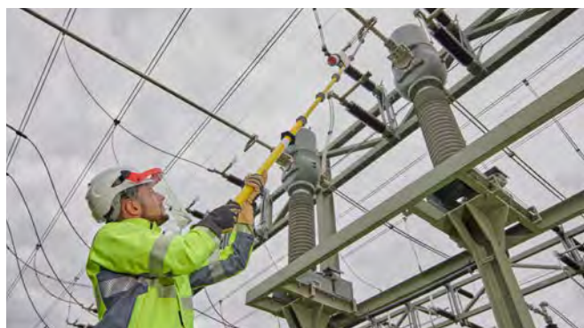
Spannungsprüfer PHE4 an einer Freiluftstation 110 kV.
