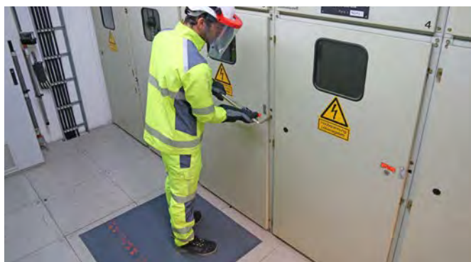
Schaltraum mit ausgelegter Isolermatte.
