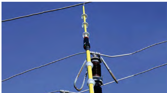
Spannungsprüfer PHE III an einer Freiluftstation 110 kV.
