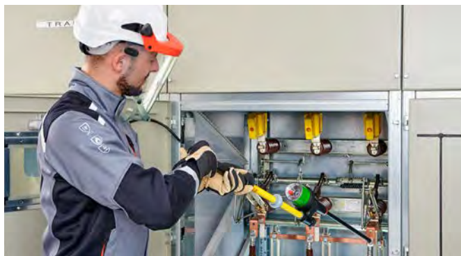
Einpoliger Phasenvergleich PHV I an einer Schaltanlage.
