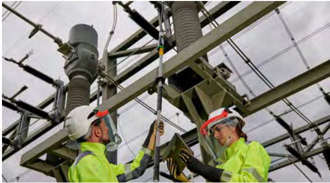
Abstands-Spannungsprüfer ASP in einer Freiluftschaltanlage.
