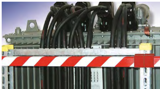
Absperrbalken montiert in Trafostation.
