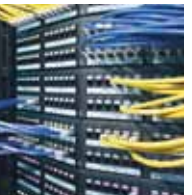
Centro de cableado estructurado
