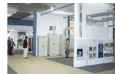
Sistema completo de distribución de energía
