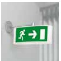
Lámparas de emergencia y control de acceso
