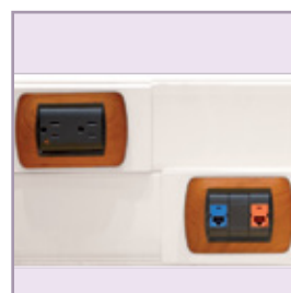
4 Tomas BTicino instaladas en ducto
