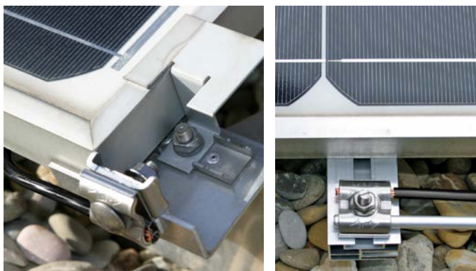
Funktionspotentialausgleich der Montagegestelle
