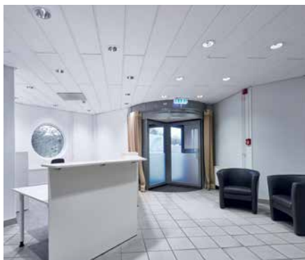
Energieeffiziente Downlight-Leuchten in der Rezeption.
