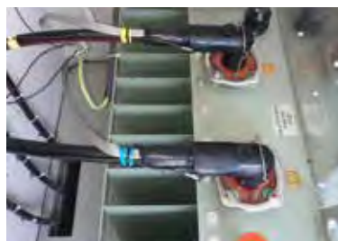
Transformatoranschluss mit 200LR
