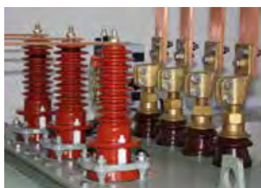
PITO-E auf Transformator mit Durchführungen
