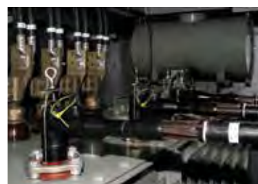
Transformatoranschluss mit 158LR
