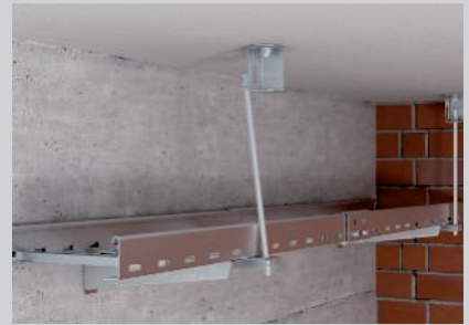
Deckenbefestigung der Gewindestangen mit Brandschutzbügel.
