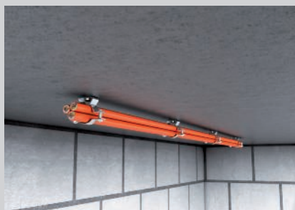
Gebündelte Kabelverlegung unter der Decke.
