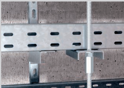
Gewindestangenbefestigung an der Kabelrinne bei mehrlagiger Anordnung.
