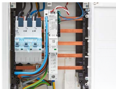
Einspeisung über einen Einspeiseadapter und Spannungsabgriff über eine Sammelschienenbox.
