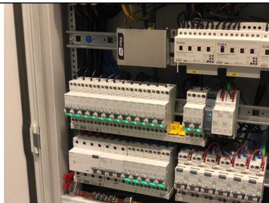
Datei: 02 iHaus Pro Server mit Siemens Sentron Schutzschaltgeräten
