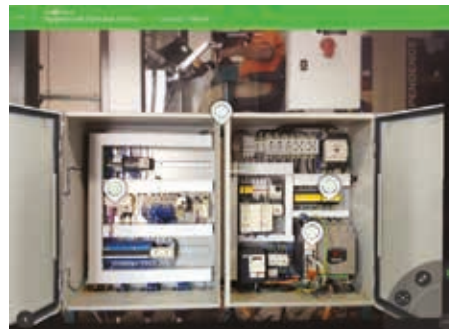
Virtuell geöffneter Schaltschrank
