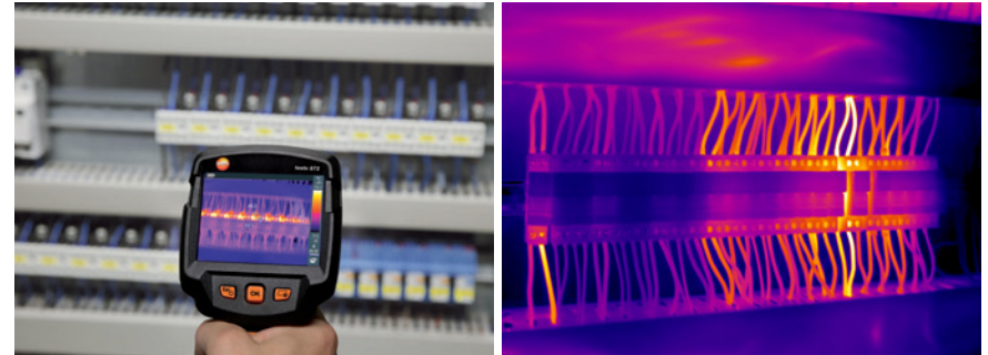
Thermisch auffällige Bauteile in Elektroschaltschränken werden ebenso schnell entdeckt...
