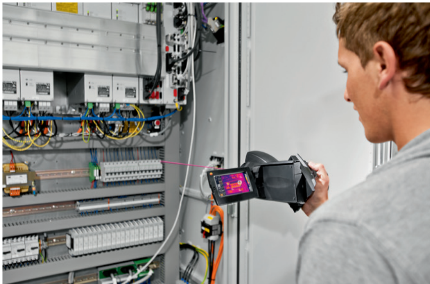
Per Thermografie-Kamera lassen sich Fehler lokalisieren, Anlagen instand halten, Schäden vorbeugen und Gefahren erkennen.
