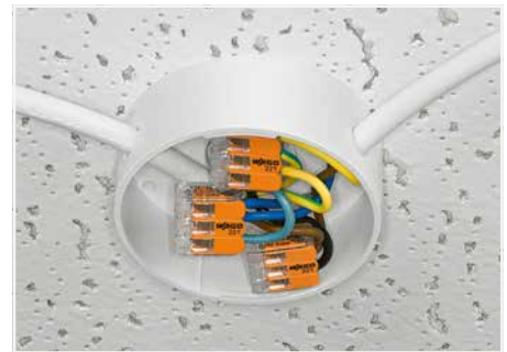
Leuchtenverteilung in Deckenbaldachin
