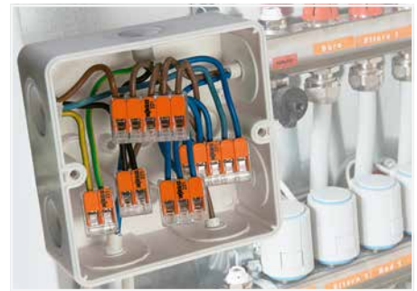
Verdrahtung feindrähtiger Leiter in Installationsdosen
