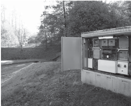
Bild 6.1 Anschluss an eine Kabelnetzstation Foto: Stadtwerke Witten GmbH, Witten
