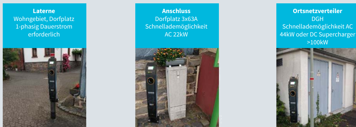
Abbildung 7: Installationen an bestehender Infrastruktur
