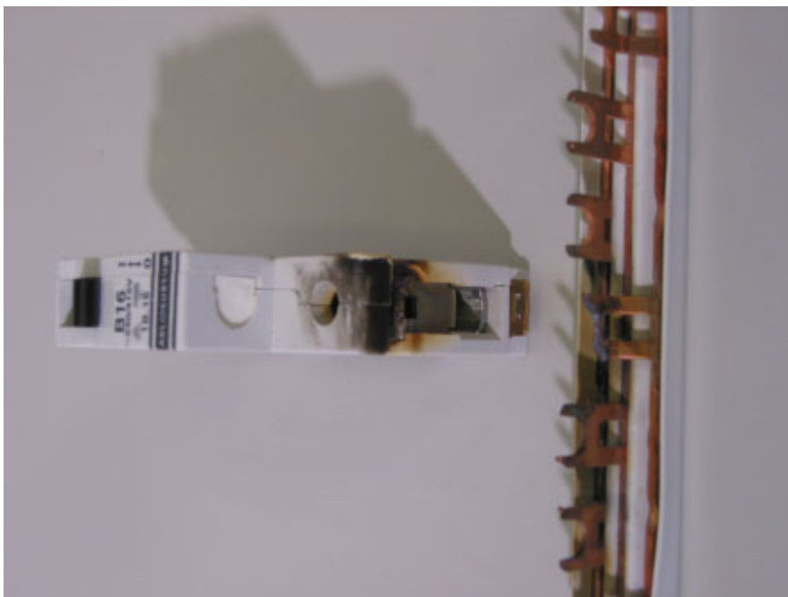
Bild 4: Schmorstelle an einem Leitungsschutzschalter
