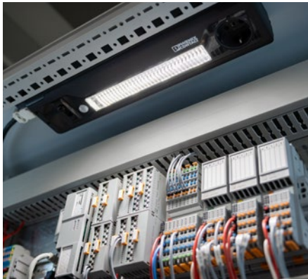
AC-Leuchte im Schaltschrank montiert.
