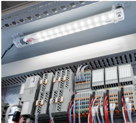
Standardleuchte im Schaltschrank montiert
