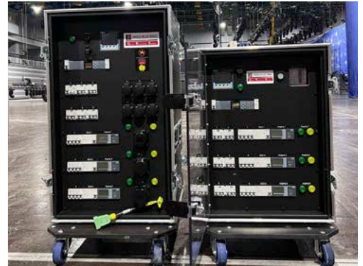
Konzertverteiler mit Differenzstromüberwachung jedes Steckdosen-Endstromkreises durch Leitungsschutzschalter SENTRON 5SL6016-7MF mit RCM- und Energiemonitoring-Funktion – und mit RCD-Schutz der Steckdosen durch FI-Schutzschalter SENTRON 5SV3 und kompakte FI/LS-Schalter SENTRON 5SV1
