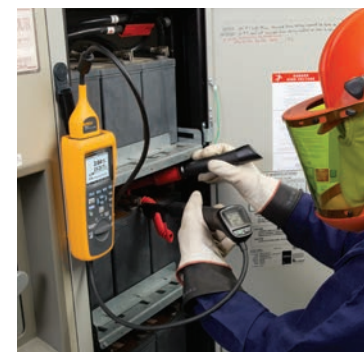
Impedanzmessung mit dem Batterieanalysator BT521
