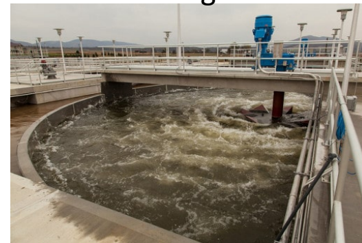
Tratamiento de aguas residuales
