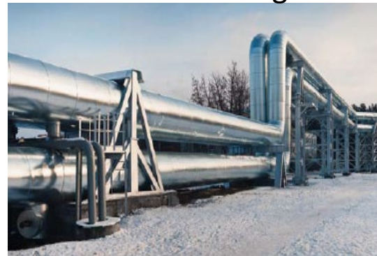
Distribución de agua
