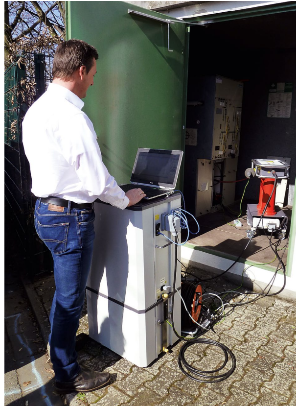
TDS NT 40 y Detector PDS 60 combinados para el ensayo del tendido de cables y calidad de la instalación
