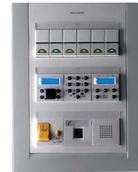
2005 Sistemas de Centralización
