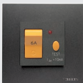
Interruptor magnetotérmico y diferencial
