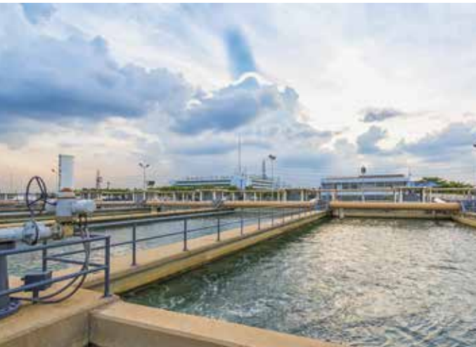
Depuradoras - E.D.A.R. - E.T.A.R.
