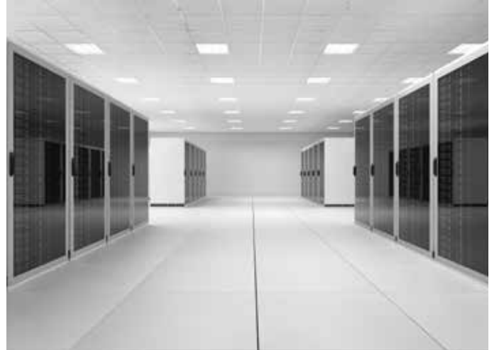
Centro de Proceso de datos - Data Centers
