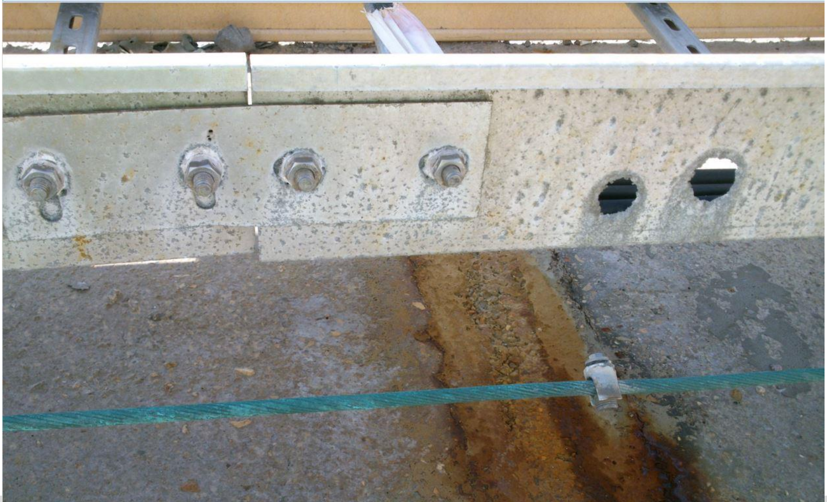
Corrosión Galvánica del Al con Cu en ambiente extremo
