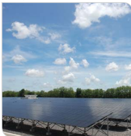
> Planta fotovoltaica de 7,5 MW (Phetchabun, Tailandia)
