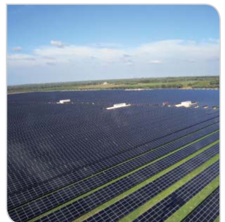
> Planta fotovoltaica de 43 MW (Plugia, Italia)
