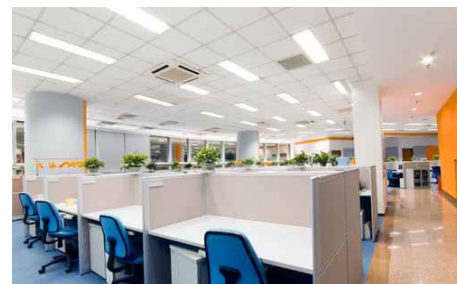
Alumbrado general en oficinas
