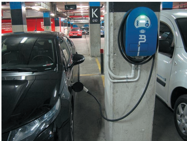
Figura 4. Terminal inteligente en garaje.
