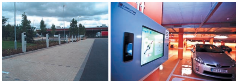
Figura 7. Puntos de recarga múltiples integrados en sistemas centralizados: aeropuerto de Heathrow (UK), Parc Científic BCN.
