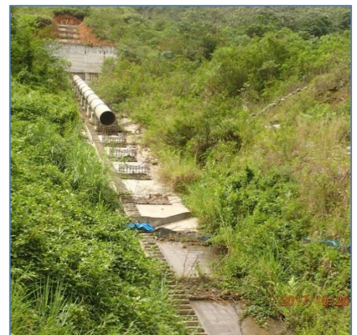
Tubería de presión
