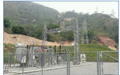
Vista de Subestación Renovandes H1
