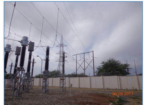
S.E. Zorritos: zona para el Banco de Condensadores
