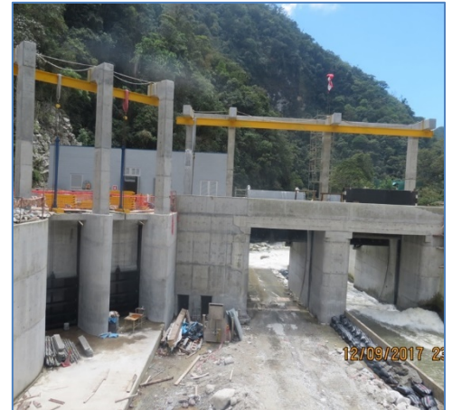
Compuertas de Bocatoma y radiales de regulación
