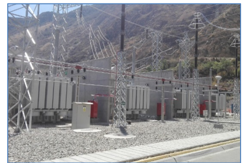
Autotransformadores 500/220/33 kV S.E. Colcabamba
