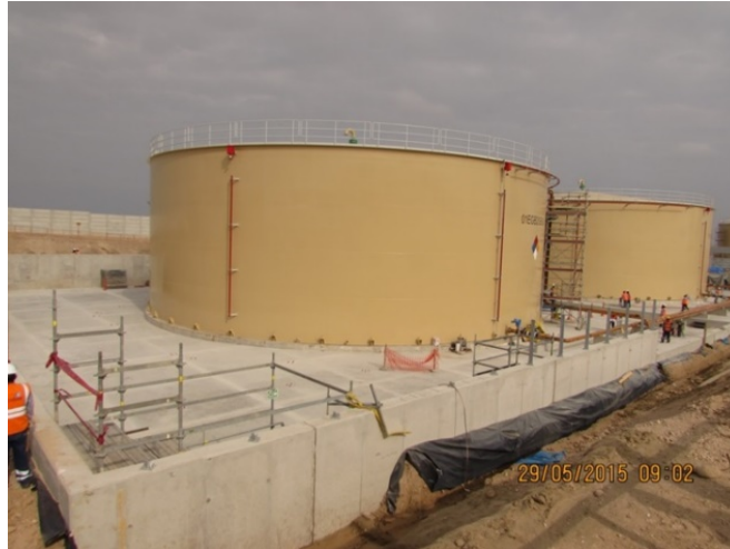
Ilustración 5: C.T. Recka (Tanques de Almacenamiento de Combustible)
