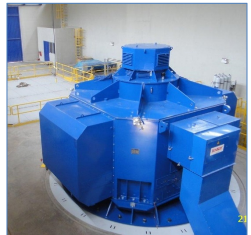
Casa de Máquinas – Generador eléctrico INDAR
