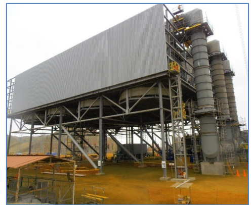
Vista general del Aerocondensador
