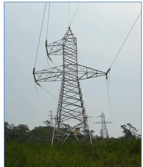
Estructura de salida de S.E. Renovandes H1
