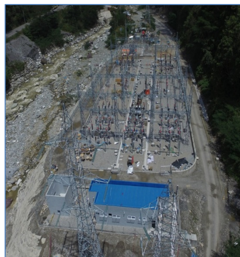
Subestación La Virgen 138 kV de doble barra
