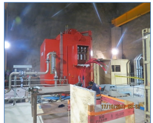
Generador Inder 6,6 kV
