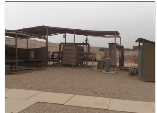
Estación de Compresión
