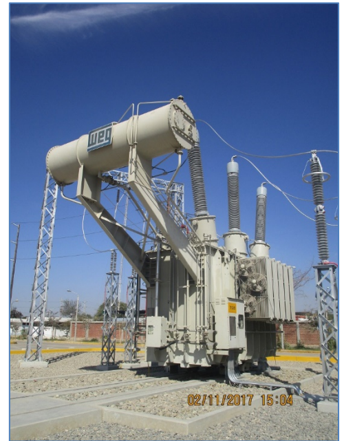
Transformador provisional de 220/60 kV – 50 MVA
