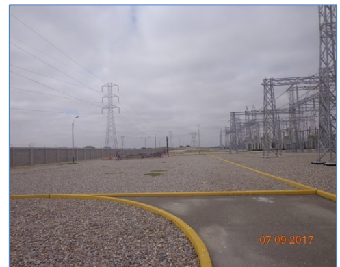
S.E. La Niña: zona donde se efectuará seccionamiento
