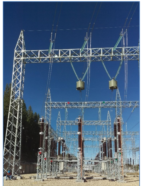
Pórtico S.E. Cajamarca Norte, salida a S.E. Cáclic
