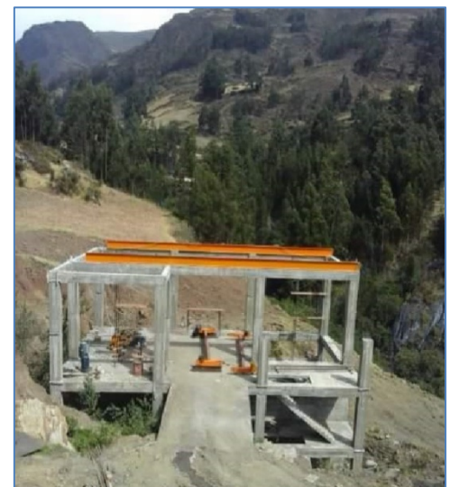
Casa de Máquinas
