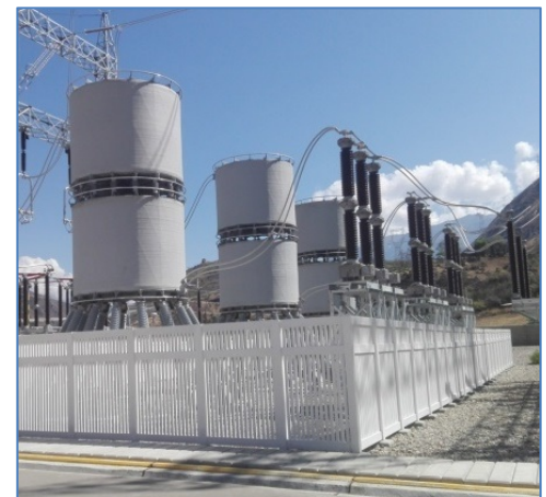
S.E. Colcabamba: reactor serie 220 kV
