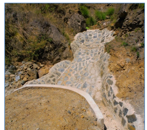
Canal de Coronación, drenaje de agua de lluvia
