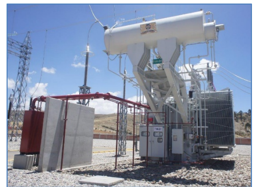
Transformador Hyosung 220/60 kV
