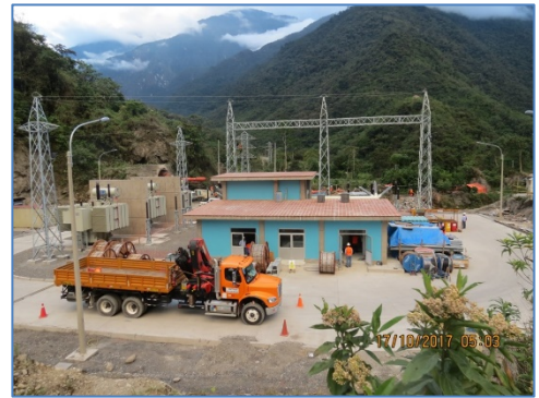
Subestación Ángel 33/138 kV
