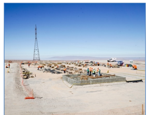
Fundaciones de equipos de subestación
