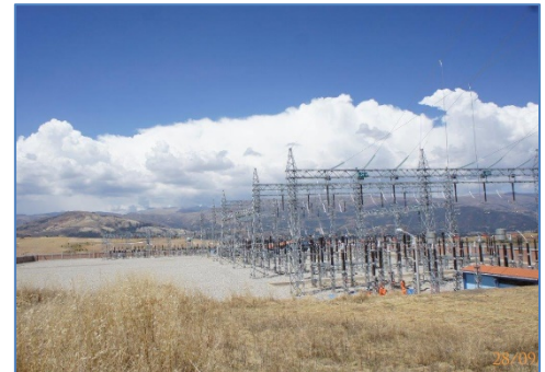
Vista de la subestación Orcotuna
