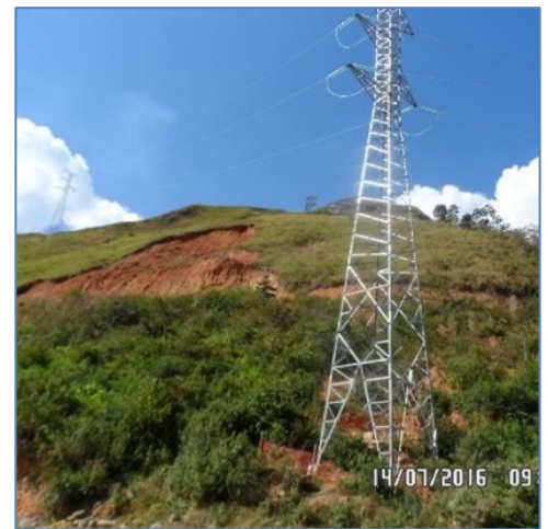
Torre de Línea de Transmisión 138 kV
