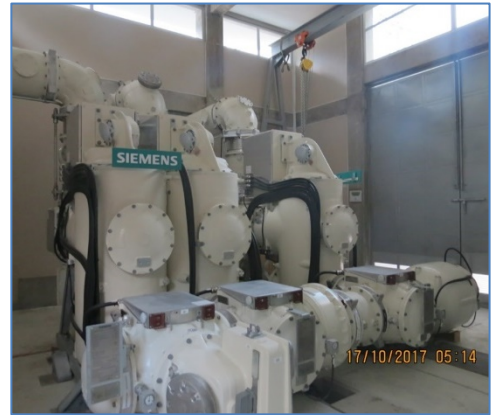
Sistema GIS 138 kV
