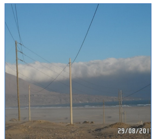
Estructuras de madera de la L.T. de 60 kV
