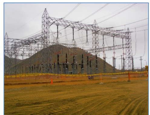
Patio de llaves en 500 kV
