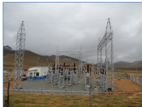
Casa de Control y patio de llaves S.E. Caripa
