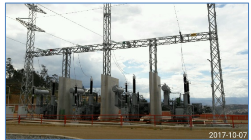
S.E. Cáclic: autotransformadores HYOSUNG
