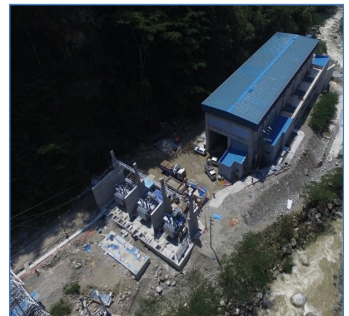
Subestación elevadora y Casa de Máquinas
