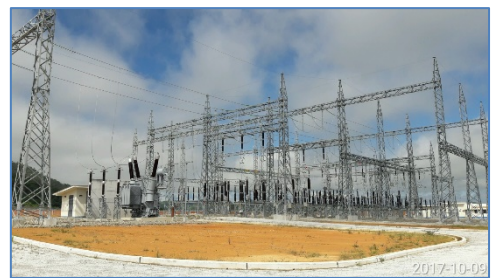
Patio de llaves de 220 kV en S.E. Belaunde Terry
