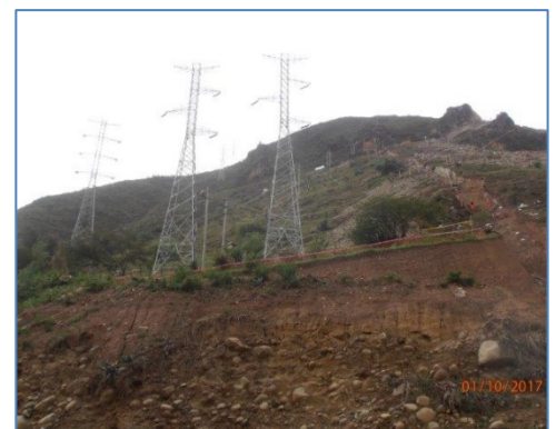
Estructuras de llegada de la L.T. en 138 kV
