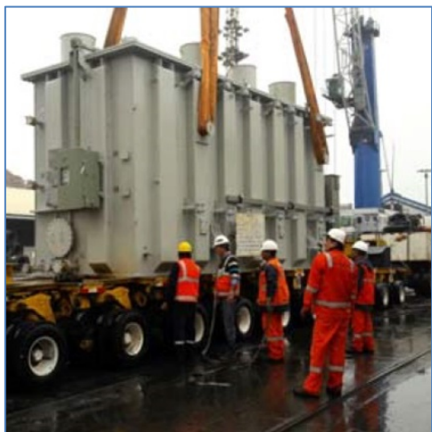
Llegada a puerto de los transformadores
