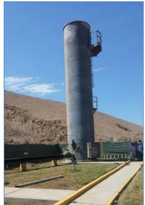
Chimenea de eliminación de CO 2
