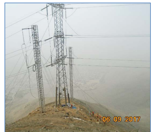
Torre T87 existente (de transposición)
