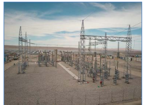
Vista de la S.E. Rubí
