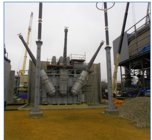
Transformador de potencia
