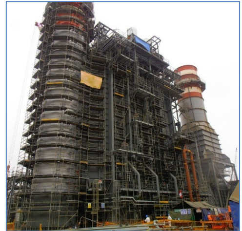
Caldera Recuperación de Calor y Chimenea
