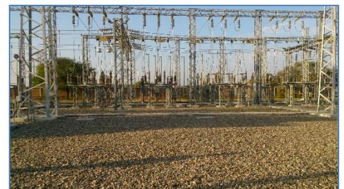
S.E. Piura: zona donde se instalará el transformador definitivo de 220/60 kV – 100 MVA
