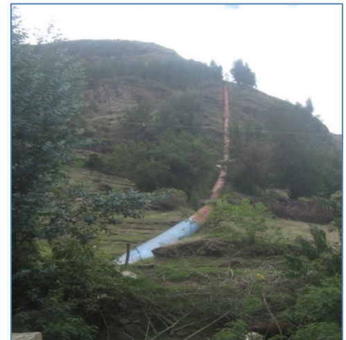
Tubería de Presión
