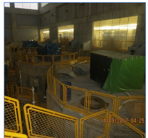
Generadores síncronos de 31,34 MVA
