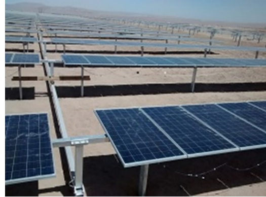
Ilustración 6: Módulos Fotovoltaicos C.S. Moquegua FV
