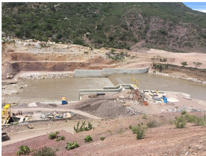
Ilustración 2: Bocatoma (C.H. Potrero)
