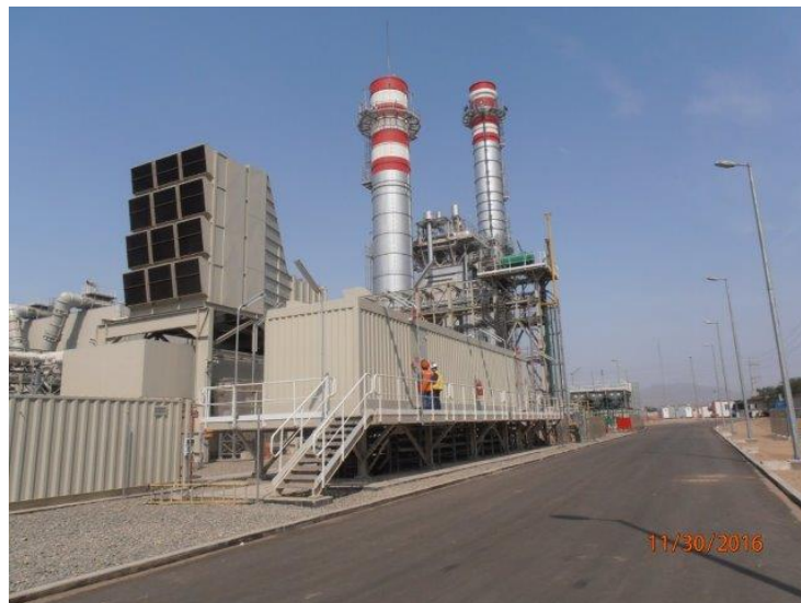
Ilustración 4: Grupo de Generación (C.T. Chilca 2)
