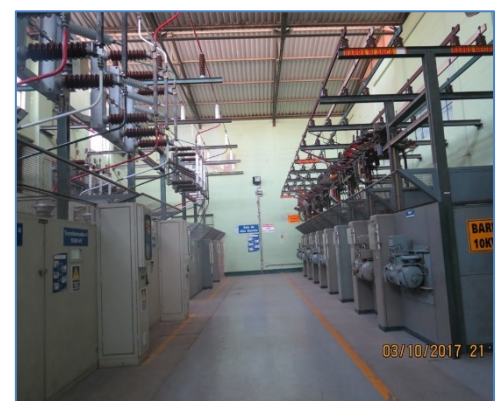
Sala de celda 10 kV S.E. Huampani
