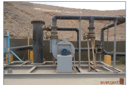
Estación de tratamiento de biogás
