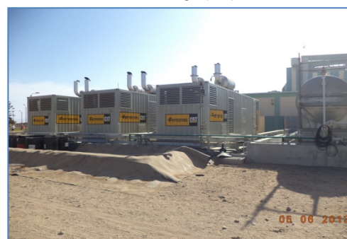
Sistema de Arranque Black Start (3x2,5 MW)
