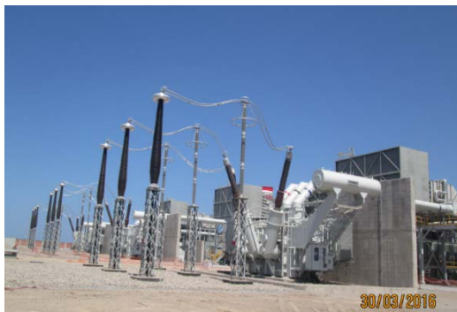
Transformadores de Potencia
