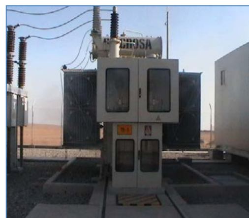
Transformador de Potencia de 20 MW – 23 / 66 kV (S.E. C.S Tacna)
