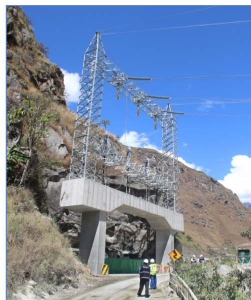
Pórtico 220 kV L-20149 Santa Teresa-Suriray
