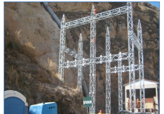
Pórtico de la S.E. Canchayllo
