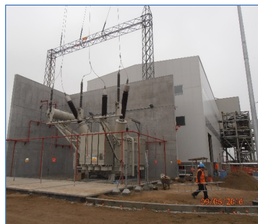
Transformador de potencia asociada a la TV
