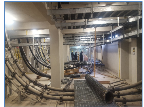
SE Industriales: ingreso de cables a SE GIS
