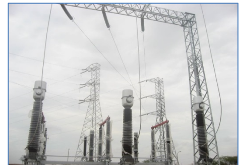
Ingreso a S.E. Piura Oeste
