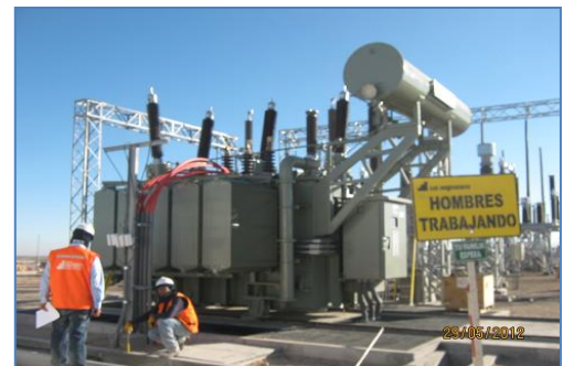
Transformador de Potencia 20 MVA, 23/138 kV (S.E. Central Majes Solar (S.E. Pedregal))
