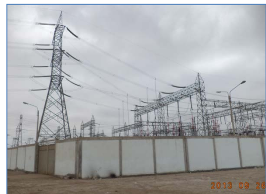
Pórtico de la S.E. Santo Domingo de los Olleros
