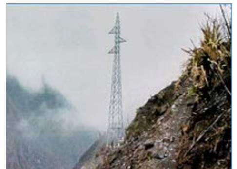
Estructura de la L.T. 72,5 kV Carpapata III-Carpapata I
