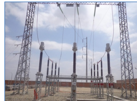
Patio de Llaves 220 kV de la S.E. Piura Oeste
