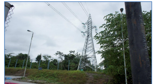
Primera torre de salida de la C.T. Iquitos
