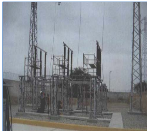
Pruebas eléctricas al seccionador de línea
