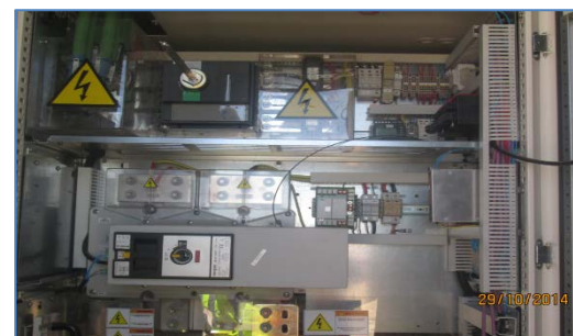
Vista del conexionado del inversor
