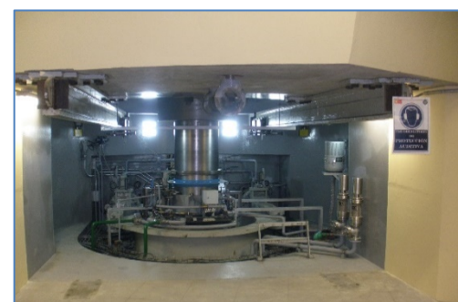
Eje de Acoplamiento Turbina-Generador Eléctrico
