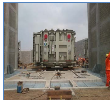
Transformador de 250 MVA (S.E. Trujillo)
