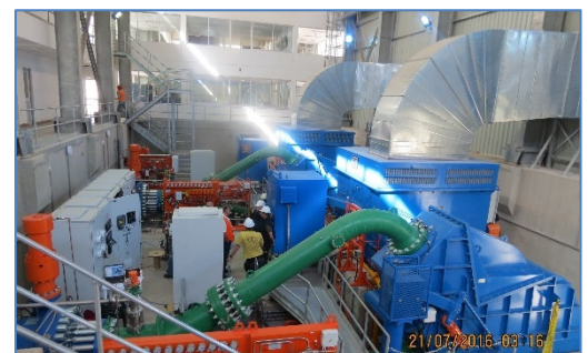
Casa de Máquinas
