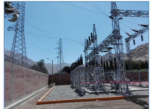
Torre de Llegada a S.E. Andahuasi
