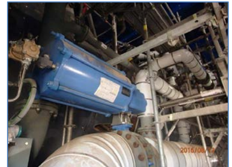
Instalaciones del Grupo N° 1
