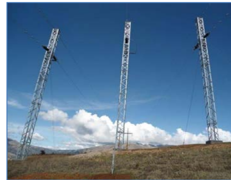
Estructura de la L.T. 60 kV S.E. Andahuaylas – S.E. Chilcayoc
