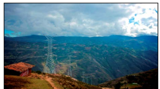
Vista Panorámica de la L.T. 220 kV Chaglla - Paragsha
