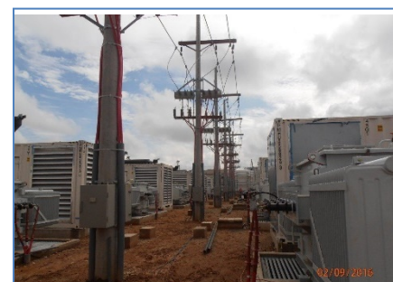
Sistema de Barras en 22,9 kV
