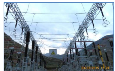
Vista de la S.E. Suriray
