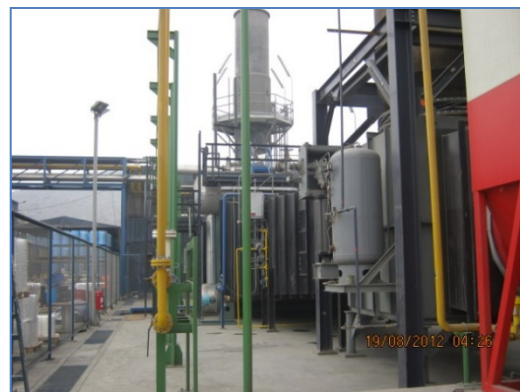
Instalaciones de C.T. Huachipa
