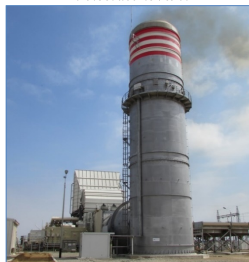
Unidad de generación turbina a gas
