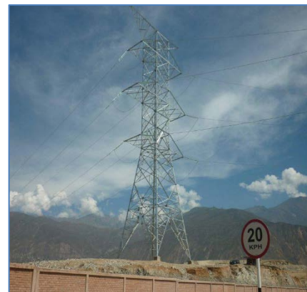
L.T. 220 kV S.E. Conococha-S.E. Kiman Ayllu
