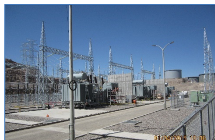
Transformadores 220/34,5 kV-150 MVA (S.E. San Luis)
