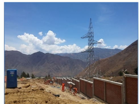
Muro Perimetral de la S.E. Amarilis 138 kV y Torre N° 1 a S.E. Piedra Blanca (L-1121)
