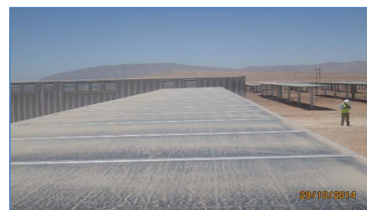
Vista de los módulos instalados
