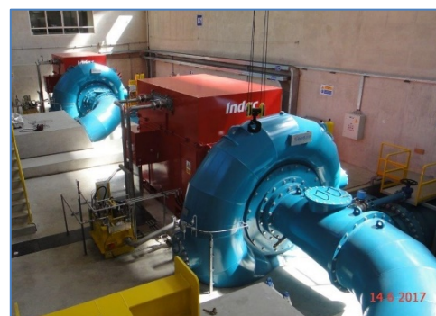
Casa de Máquinas con dos Turbinas Francis
