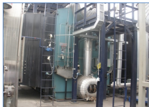
Caldera de Recuperación de calor
