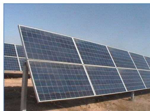
Módulos Solares Instalados
