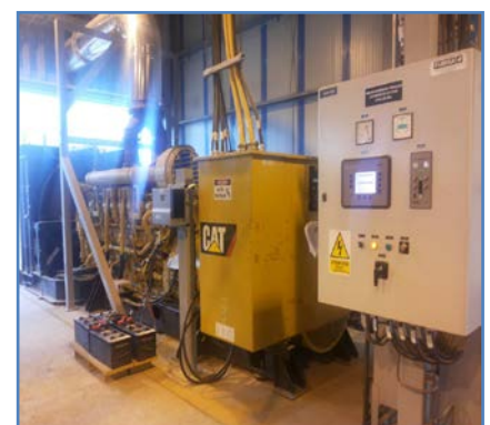
Generador Diesel N° 1
