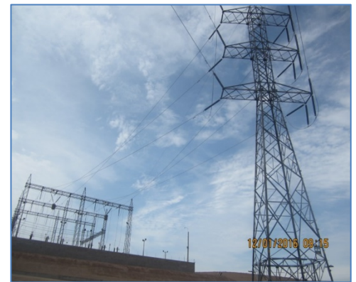
Torre N° 1 de la L.T. 220 KV Ilo 3 – T46
