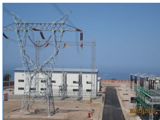
Patio de Llaves y Subestación Puerto Bravo
