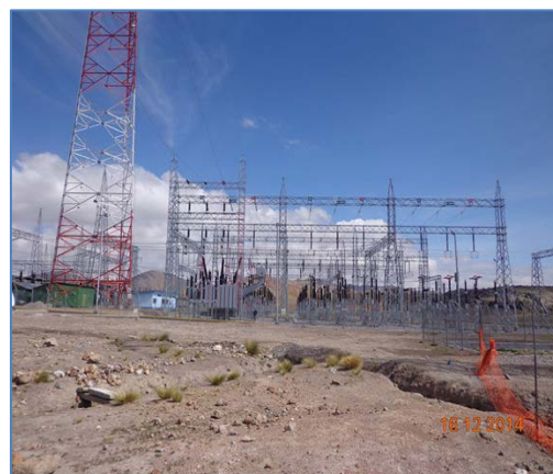
Patio de Llaves 220 kV S.E. Cotaruse
