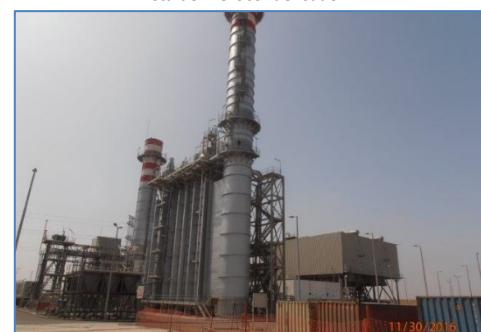
Vista de la C.T. Chilca 2
