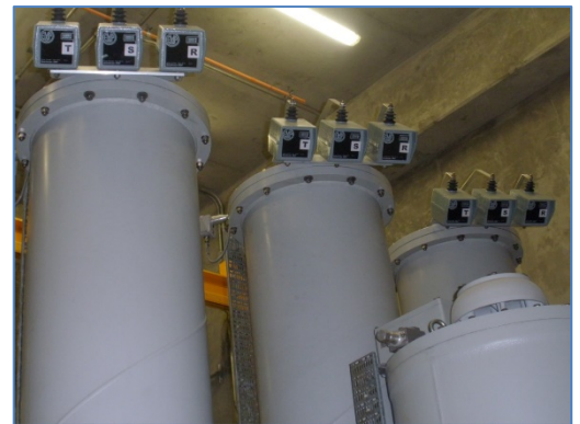
Circuitos de Salida en 138 kV
