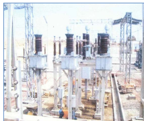
Celda 66 kV S.E. Paramonga Nueva
