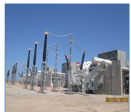
Transformadores de la C.T. Puerto Bravo
