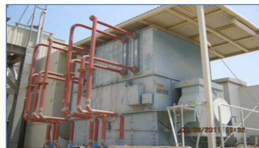
Generador Eléctrico ABB de 30 MW
