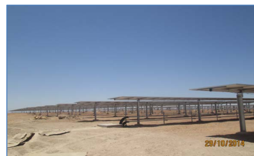
Módulos fotovoltaicos instalados
