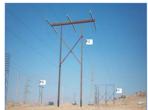
Ingreso a la S.E. Chiclayo Oeste
