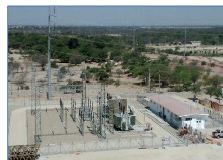
S.E. Cementos Piura
