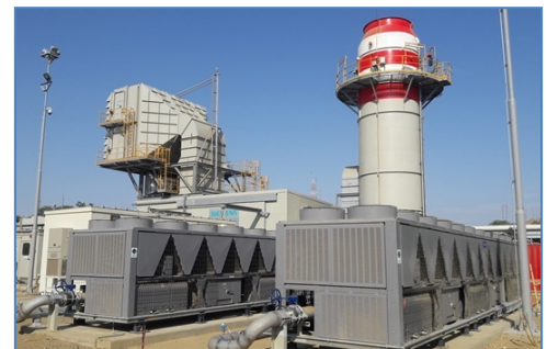
Chillers del Sistema de Enfriamiento
