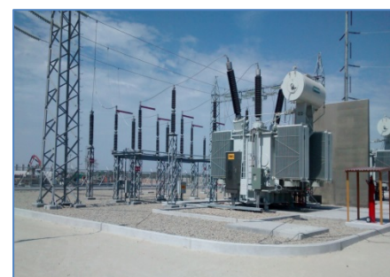
Transformador de Potencia 220/6,3 kV – 30/37,5 MVA
