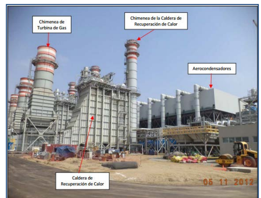
Vista de las Chimeneas de Turbinas de Gas, Calderas de Recuperación de Calor y Aerocondensadores
