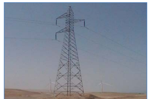
L.T. 220 kV S.E. P.E. Marcona – S.E. Marcona
