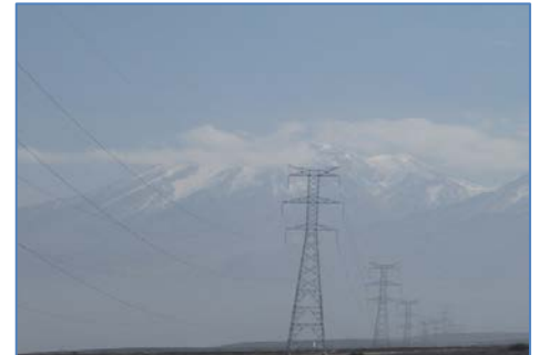
Estructuras autoportadas con doble circuito L2022 y L2023
