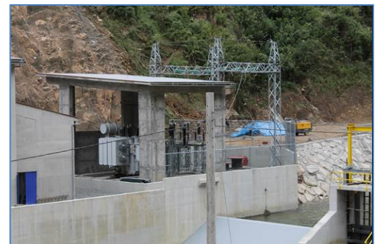
Vista de la S.E. Runatullo II
