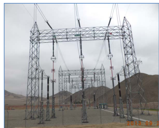
Patio de Llaves - S.E. Santo Domingo de los Olleros
