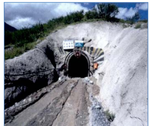
Túnel Principal Portal Salida, Tubería Baja Presión
