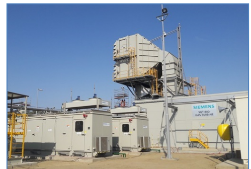
TG6 (Turbina – Generador Siemens)
