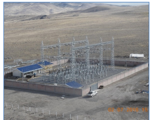
Vista de la SE Talta
