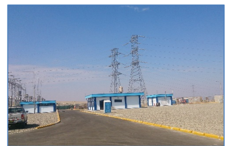
S.E. Reque (Llegada de la L.T. Éten – Reque)
