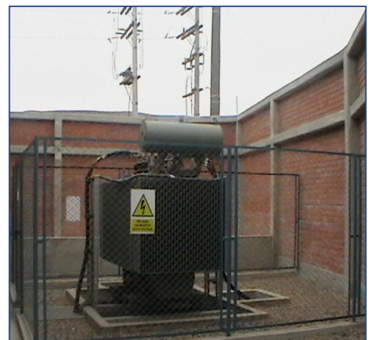
Transformador de Potencia
