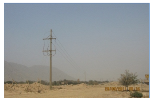
Línea de subtransmisión 22,9 kV
