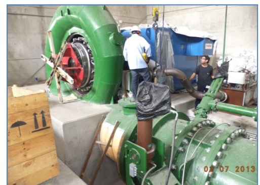
Turbina Rodete N° 2
