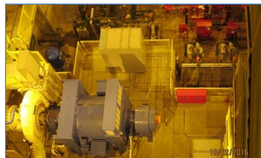
Casa de máquinas de la Pequeña Central Hidroeléctrica
