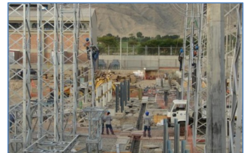
Ampliación S.E. Independencia 60 kV
