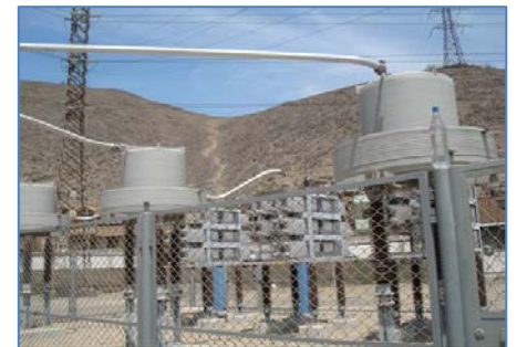
Banco de Condensadores S.E. Chavarría
