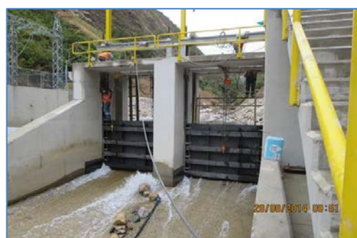
Compuertas del barraje móvil
