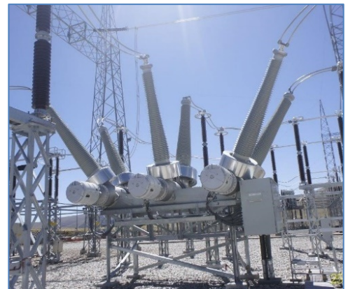
Interruptor de tanque muerto
