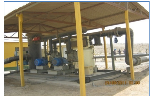
Planta de tratamiento de Biogás
