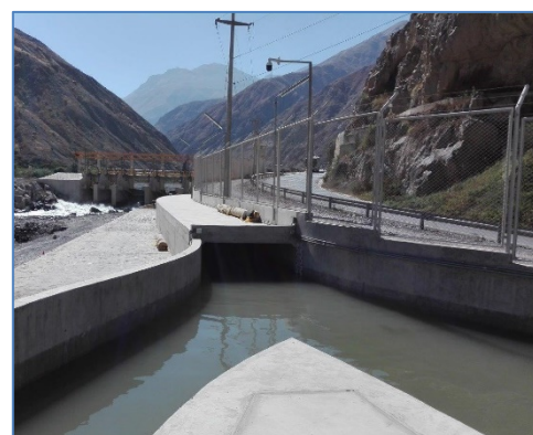
Bocatoma y Canal de Conducción
