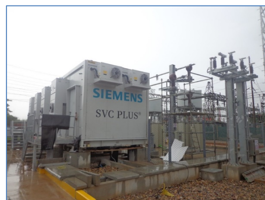
S.E. Pucallpa (SVC) - Patio SVC
