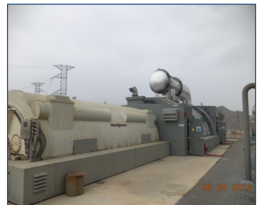
Turbina de Vapor
