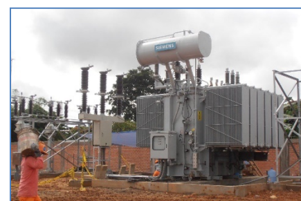
Transformador de Potencia de 50 MVA (22,9/60 kV)
