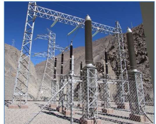
Patio de llaves S.E. Cheves
