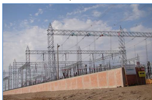
Subestación San José
