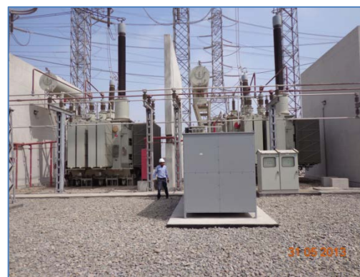
Resistencia neutro Autotransformador. 500/220 kV S.E. Chilca
