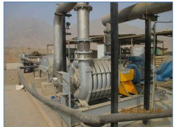
Planta de tratamiento de biogás
