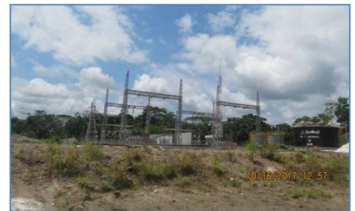
Subestación de salida
