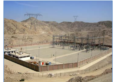
Subestación La Planicie
