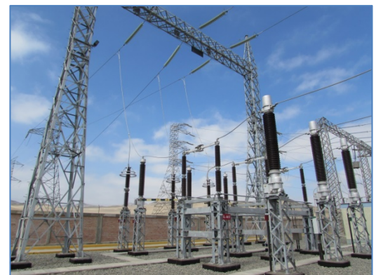
Celda de llegada en S.E. Huacho
