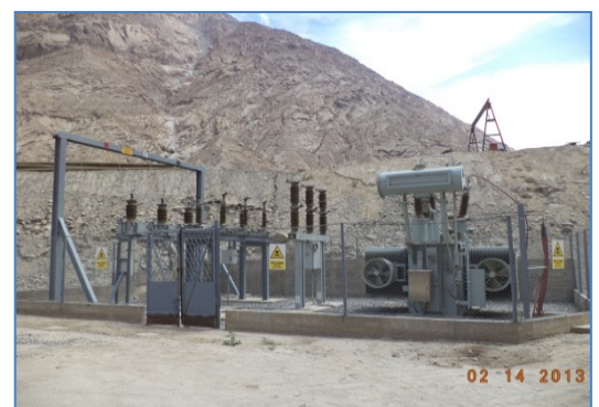
Subestación Eléctrica de la C.H. Yanapampa
