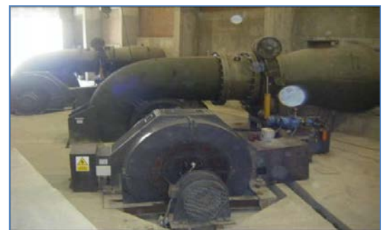
Turbina y Generador del Grupo 3
