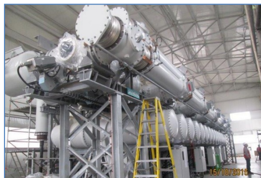
Subestación GIS - C.T. Puerto Bravo
