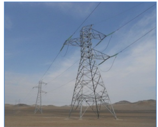
L.T. 220 KV S.E. Cheves-S.E. Huacho
