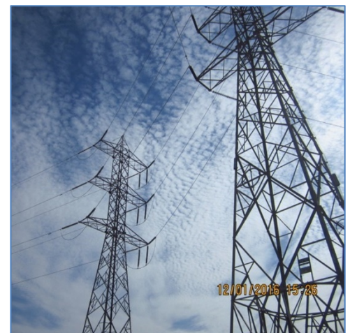
Interconexión de L.T. 220 KV Ilo 3 – T89 con T46
