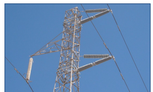
Conjunto de Aisladores Line Post en L-2209
