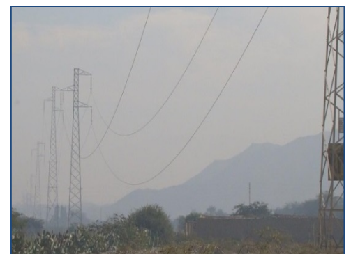
Torres de alineamiento con aisladores de suspensión
