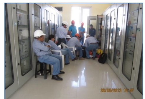
Pruebas End To End en S.E. Piura
