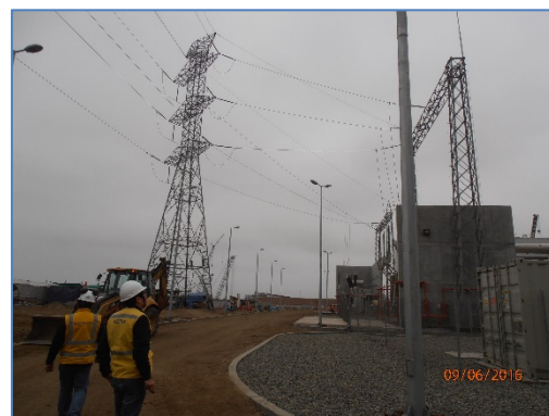
Pórtico y 1ra estructura de la L.T.
