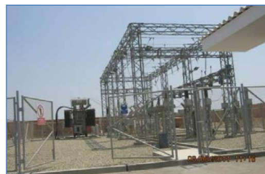
S.E. de Tablazo (Equipos del Patio de Llaves)
