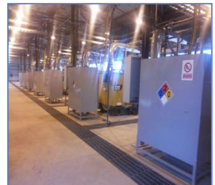
Vista de los 7 grupos electrógenos Diesel
