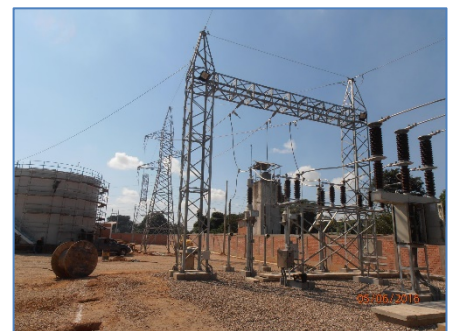
Subestación de Salida en 60 kV C.T. Pucallpa
