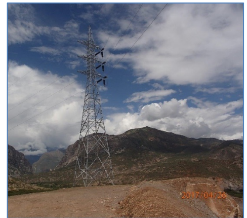
Torre de la Línea de Transmisión
