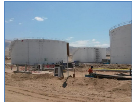
Tanques de almacenamiento de Combustible
