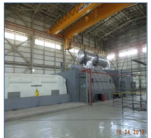
Unidad de Generación (Turbina a vapor)
