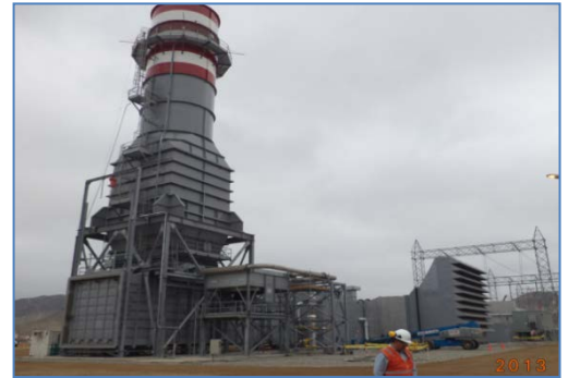
Turbina a Gas de la S.E Santo Domingo de los Olleros
