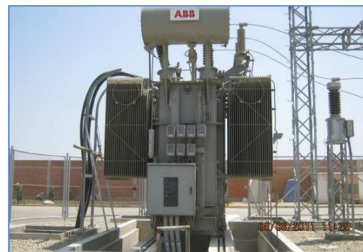
Transformador ABB de 42 MVA 60/13,8 kV
