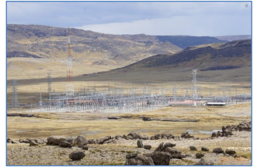
Vista de la subestación Cotaruse
