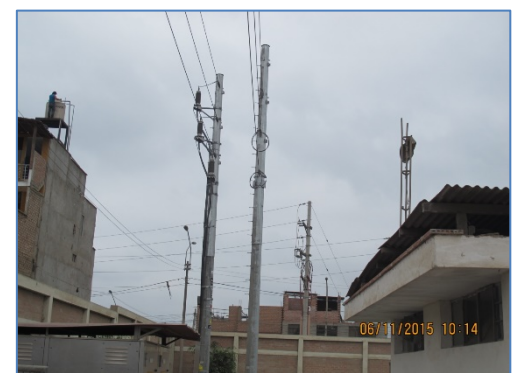
Poste de Llegada a la S.E. Huaral
