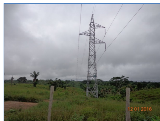
Nueva Torre 153A (entre T153 y T154) de la L.T. Aguaytía-Pucallpa
