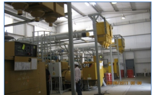
Grupos de Generación 3 x 1,6 MW
