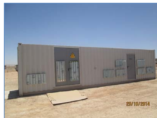
Caseta de transformador e inversores
