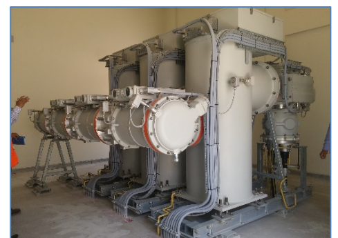
Subestación GIS en 60 kV
