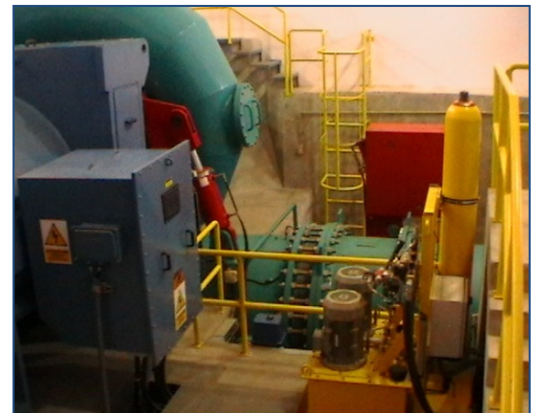
Turbina y Generador
