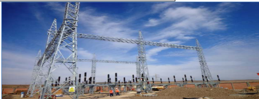
Vista Subestación Marcona
