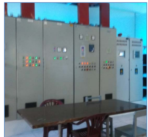
Sala de Tableros de Control y Mando
