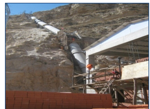
Vista de la Tubería Forzada-Casa de Máquinas
