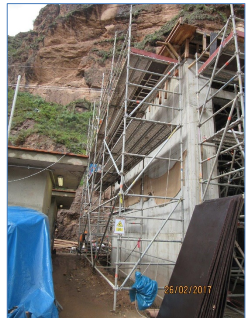
Vista lateral S.E. Marañón
