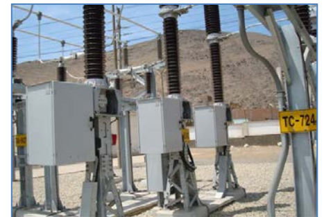
Interruptores instalados S.E. Chavarría
