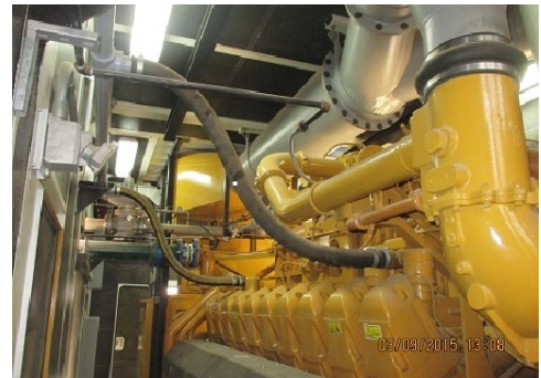
Ilustración 5: Grupo Generador N° 2 (C.B. La Gringa V)
