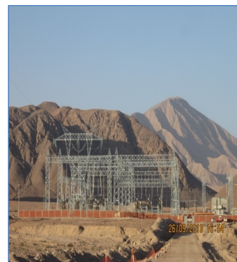
Vista Panorámica Exterior de la S.E. Montalvo
