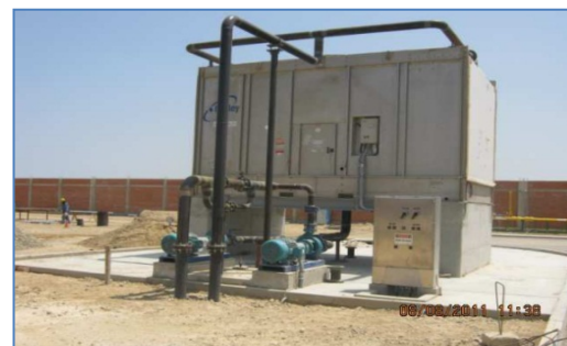
Torre de Enfriamiento de la Planta
