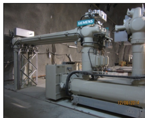
Subestación sistema GIS, en caverna
