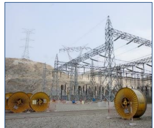
Celdas y torre de salida SE La Planicie
