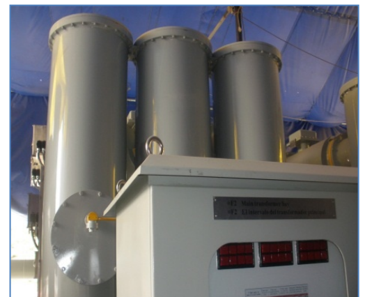
Equipamiento de la S.E. GIS Huanza
