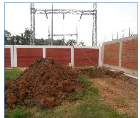
Subestación Puerto Maldonado de Electro Sur Este
