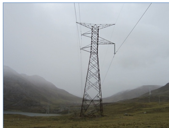
Torre de la LT 220 kV Pachachaca – Pomacocha (Ampliación de capacidad de 152 MVA a 250 MVA)
