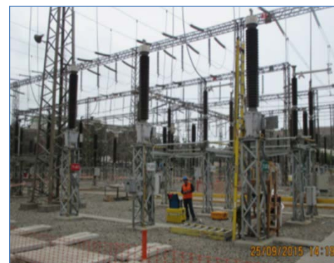
Pruebas SAT en Equipos Primarios (S.E. Ventanilla)
