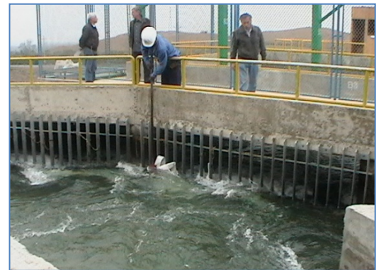
Zona de Captación
