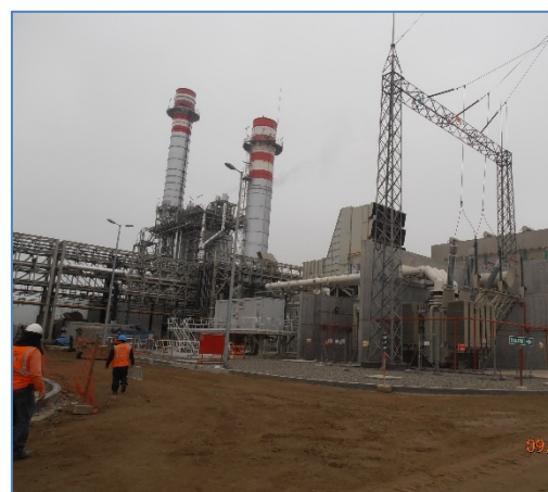
Transformador de potencia asociada a la TG
