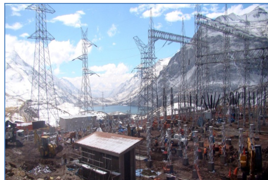
Vista de la S.E. Pomacocha
