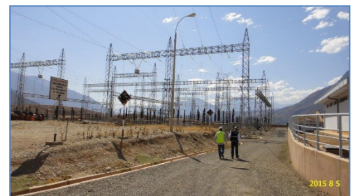
S.E. Kiman Ayllu (220 kV)
