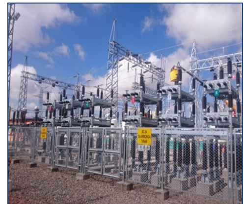
Subestación Puno (Bancos de Compensación Capacitiva)
