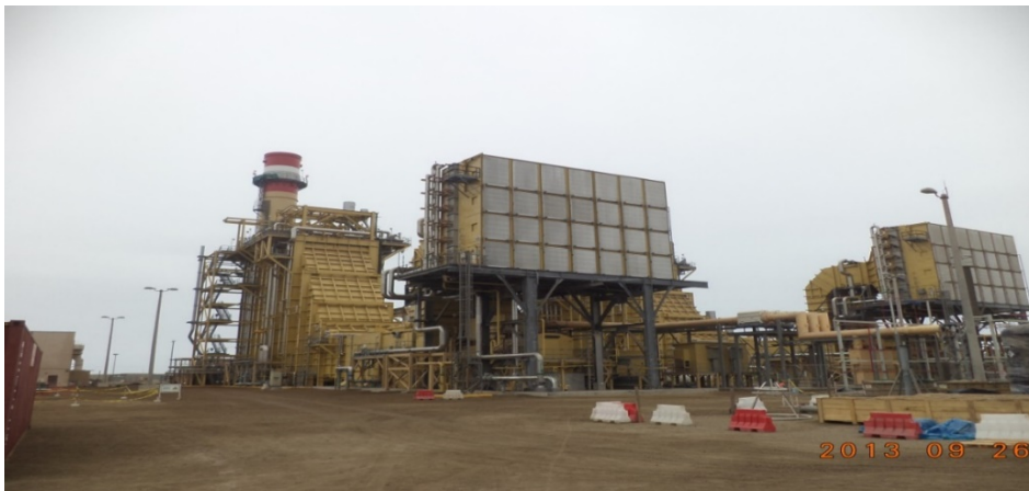
Ilustración 3: Turbinas a Gas y Turbinas de Vapor - C.T. Chilca (534,3 MW)
