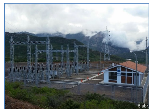
Subestación. Aguas Calientes
