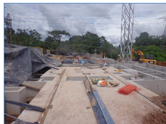
S.E. Aguaytía - Patio 220 kV
