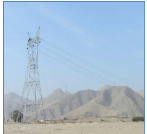
Estructura Autosostenida de la L.T. 500 kV S.E. Fénix – S.E. Chilca
