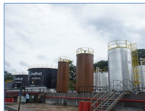
Tanques de combustible, aceite y agua
