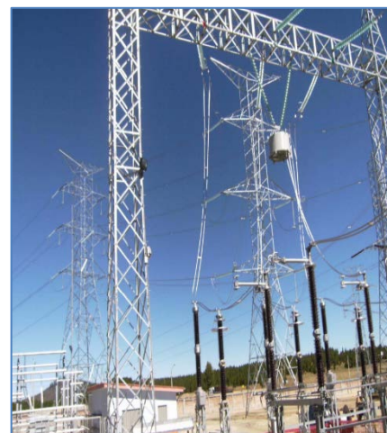
Llegada a la Subestación Cajamarca Norte
