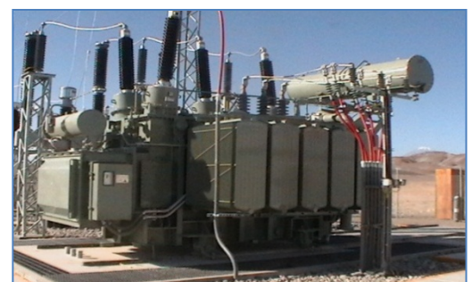
Transformador de Potencia 20 MVA, 23/138 kV
