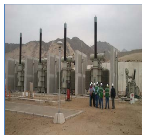
Reactores de 40 MVAR (S.E. Trujillo)
