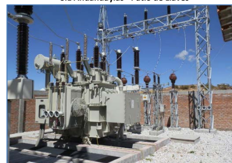
Subestación Chilcayoc-Patio de Llaves
