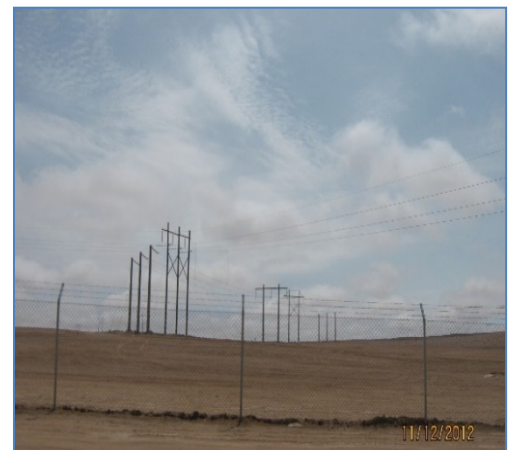
L.T. 138 kV C.S. Panamericana Solar 20 TS – S.E. Ilo 3
