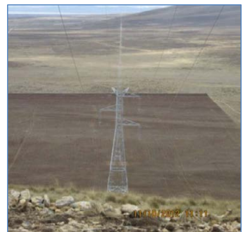
Torre con Aislamiento en suspensión
