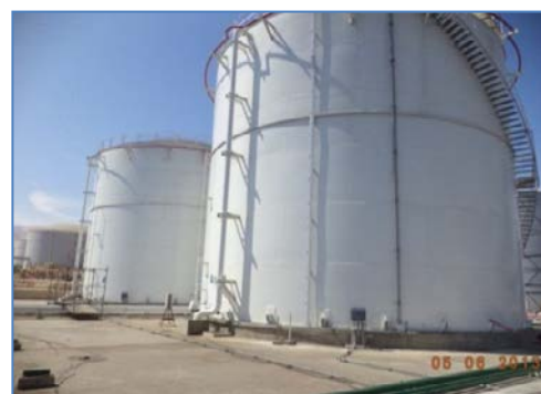
Tanques de almacenamiento de Combustible tratado B5 (2x3 000 m 3 )
