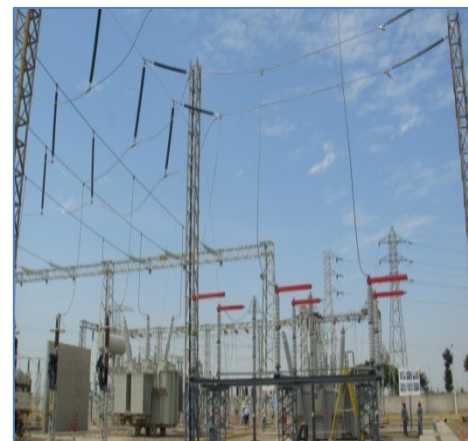
Transformador Provisional en la S.E. Guadalupe
