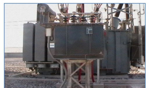
Transformador de 35 MVA – 220 kV
