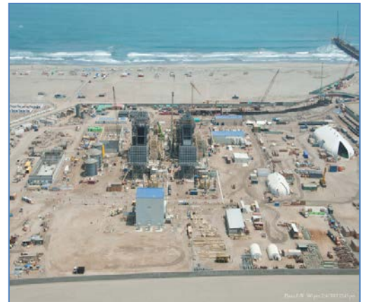
Vista de Frente de la Central
