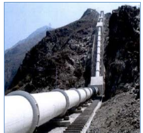
Tubería Forzada – C.H. Huasahuasi I
