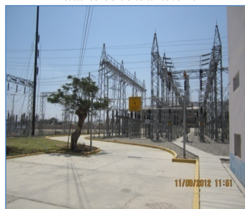
Patio de Llaves 60 kV- S.E.Independencia
