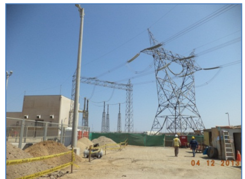
Pórtico de Salida y Subestación GIS 500 kV
