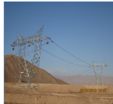
L.T. 220 kV Montalvo - Moquegua
