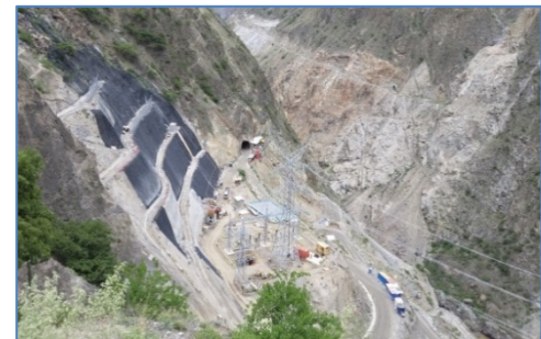
Patio de Llaves S.E. Cerro del Águila
