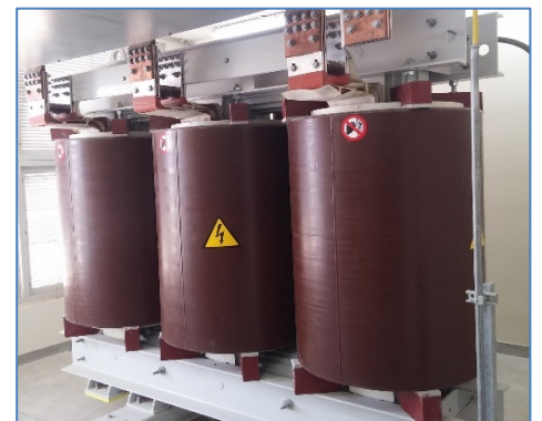
Transformador en Seco del Grupo de Generación N° 1
