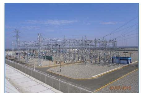
Vista S.E. Reque
