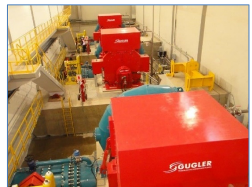
Sala de Máquinas (3 turbinas de 6,56 MW)
