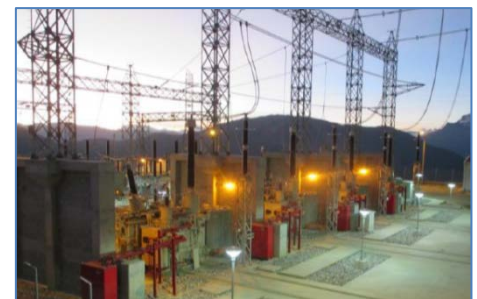
Vista Panorámica de S.E. Abancay
