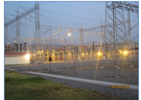
Puesta en servicio SE Socabaya y Circuito I L.T. 220 kV Tintaya - Socabaya día 15.04.14
