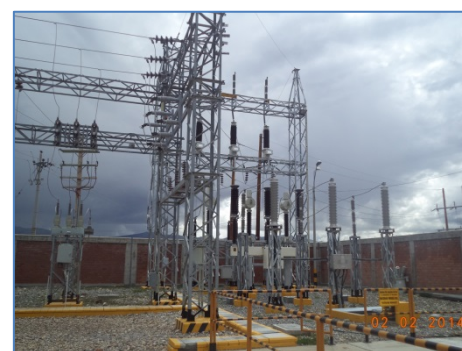
S.E. Andahuaylas - Patio de Llaves
