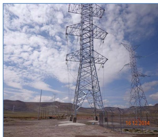
Torre N° 01 L.T., 220 kV Cotaruse-Las Bambas
