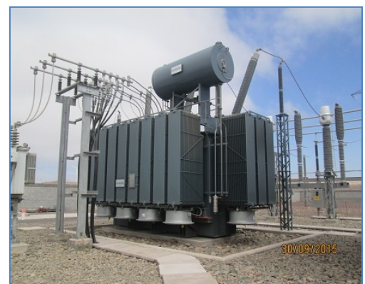
Transformador de Potencia 100 MVA
