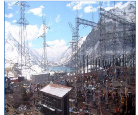
S.E. Pomacocha, bahía 220 kV
