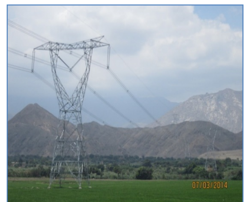
Torre N° 185 Tramo sector Limoncarro - Guadalupe
