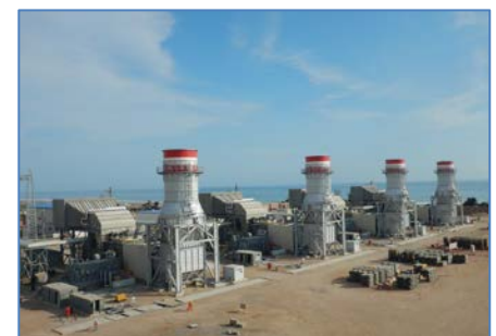
Turbinas y Generadores 1, 2, 3 y 4
