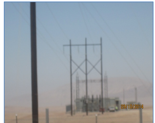
L.T. 22,9 Moquegua FV - S.E. Panamericana Solar
