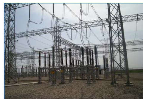
Patio de Llaves S.E. Chilca
