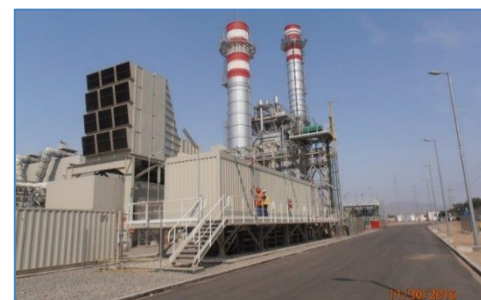
Chimeneas de los Ciclos Simple y Combinado
