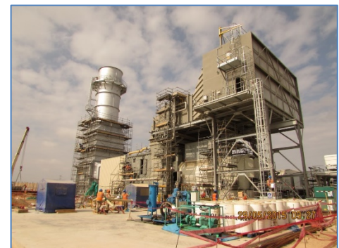
Turbogenerador y equipos auxiliares
