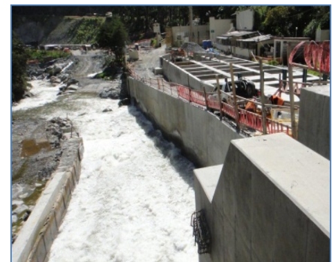
Canal de Descarga y Desarenador
