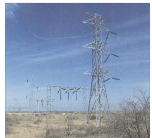
Vista de Línea de Transmisión L-2161
