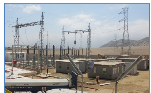
S.E. Éten y L.T. 220 KV S.E. ÉTEN – S.E. Reque
