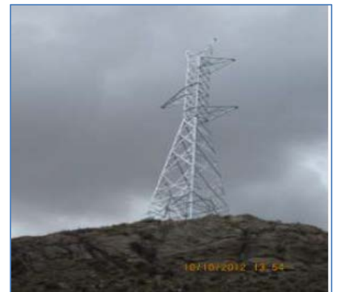
Torre Nº 19 Tipo Angulo Anclaje (AA)
