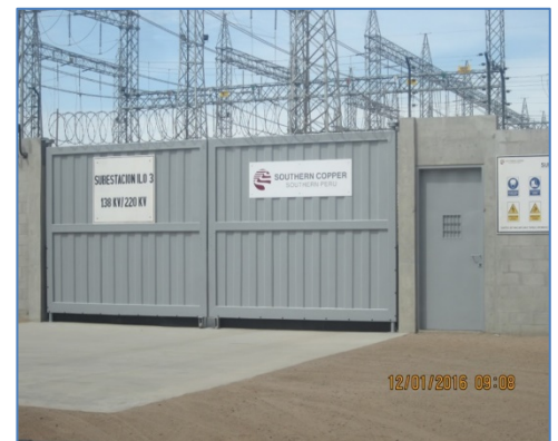
Subestación Ilo 3 220/138 KV
