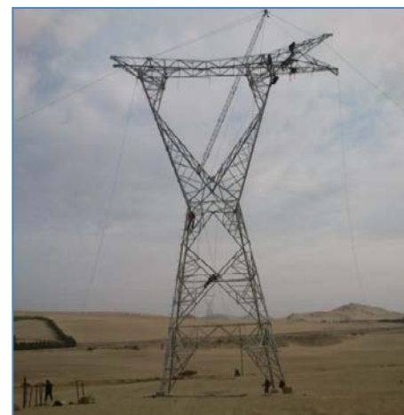
Torre Autosoportada 500 kv
