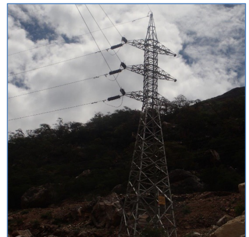
Torre de la Línea de Transmisión
