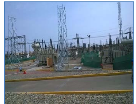
Autotransformador S.E. Trujillo
