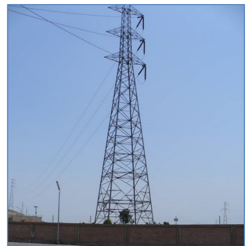
Torre N° 1 S.E. Paramonga Nueva
