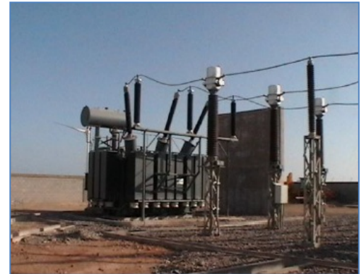
Transformador de Potencia de 35 MVA (20/220 kV)
