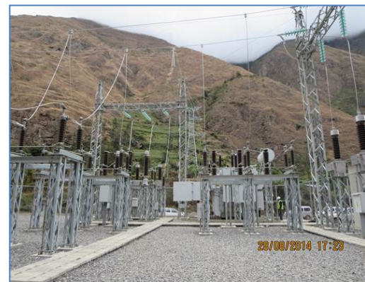
Vista Pórticos S.E. Runatullo III
