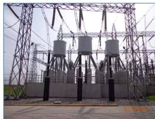
Reactor Serie entre las barras de 220 kV
