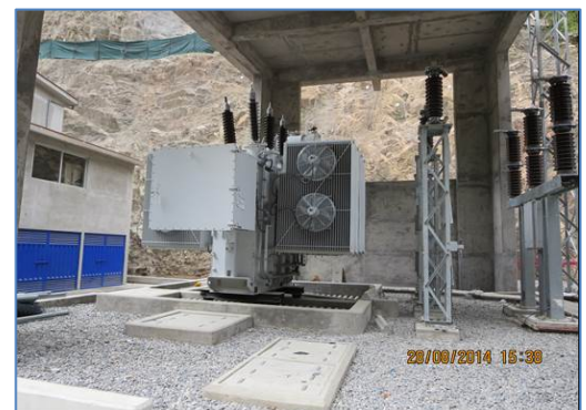
Vista del Transformador
