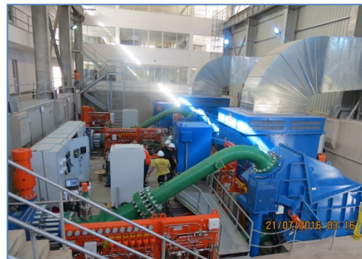
Casa de Máquinas
