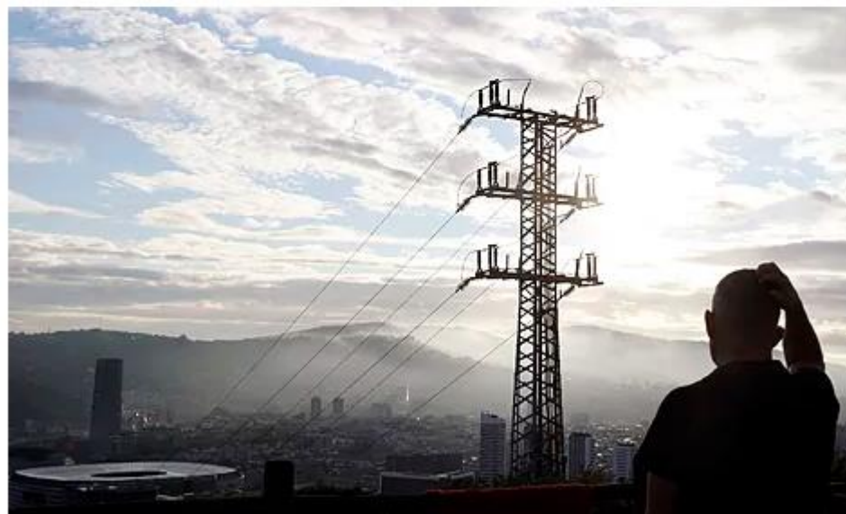
Torres de la red eléctrica en Bilbao. EFE
