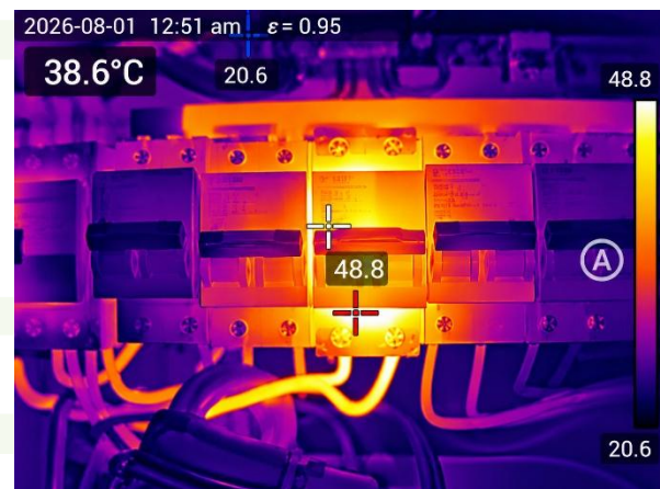
Termografía del cuadro: contraste entre circuito y conexión.
