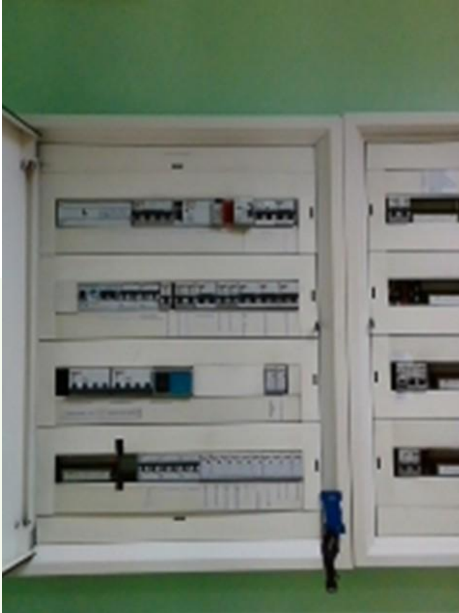
Fotografía visible de un cuadro de distribución
